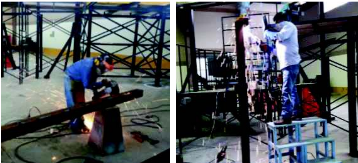
Fotografía 3-10: Corte, esmerilado, soldado y nivelado de la estructura metálica de soporte del separador de caudales.
