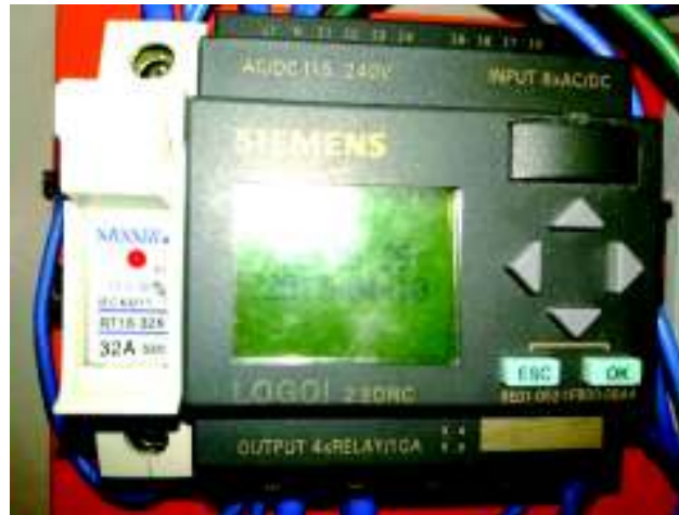
Figura 25 LOGO! funcionamiento en el tablero de control de iluminación Fuente: (Pulla, 2016)
