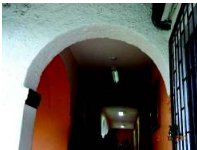
Figura 44 Encendido de luminarias con los sensores sin la manipulación de las personas.
