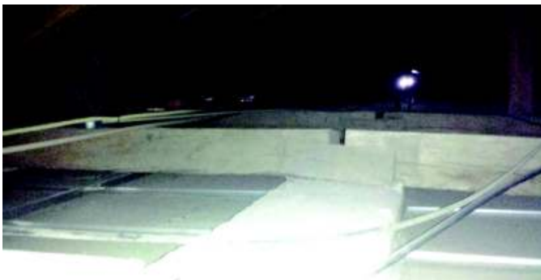
Figura 11 Instalaciones eléctricas de iluminación de la ESFOT Fuente: (Pulla, 2016)
