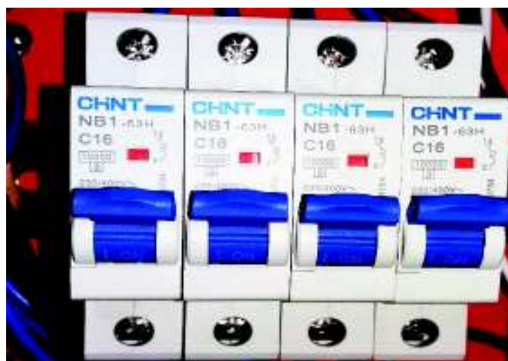
Figura 19 Breakers instalados en un riel DIN
