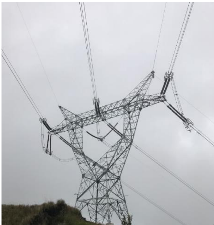
Figura A.11. Torre de transmisión 323 de la L/T Inga-Tisaleo_500 kV
