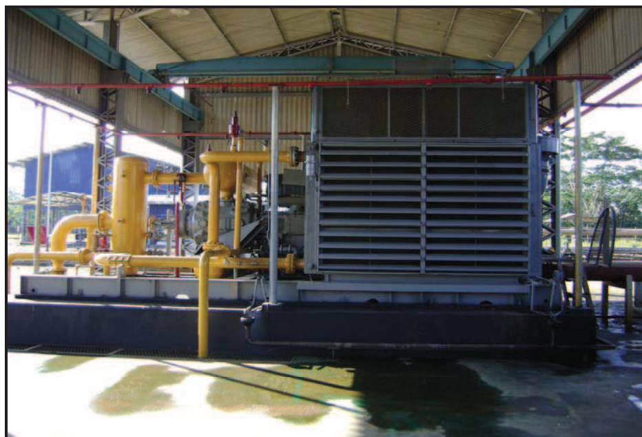
FOTO N° 1.10: SISTEMA DE CAPTACIÓN DE GAS
