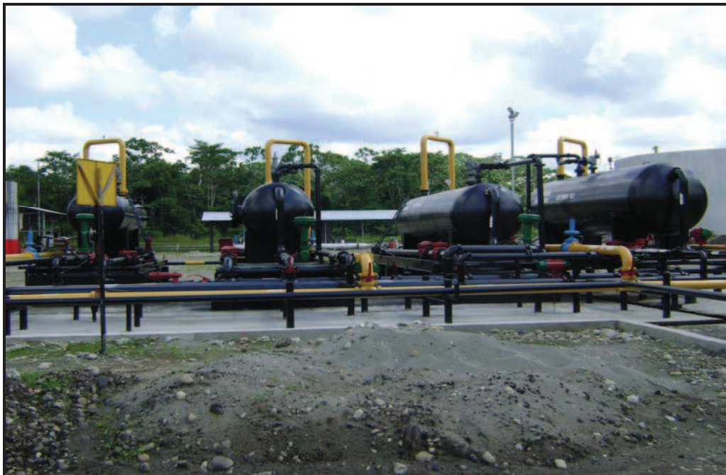
FOTO N°1.2: SISTEMA DE SEPARACIÓN PRIMARIA
