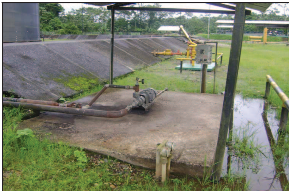
FOTO N° 1.26: SISTEMA DE RECIRCULACIÓN TANQUE-TANQUE
