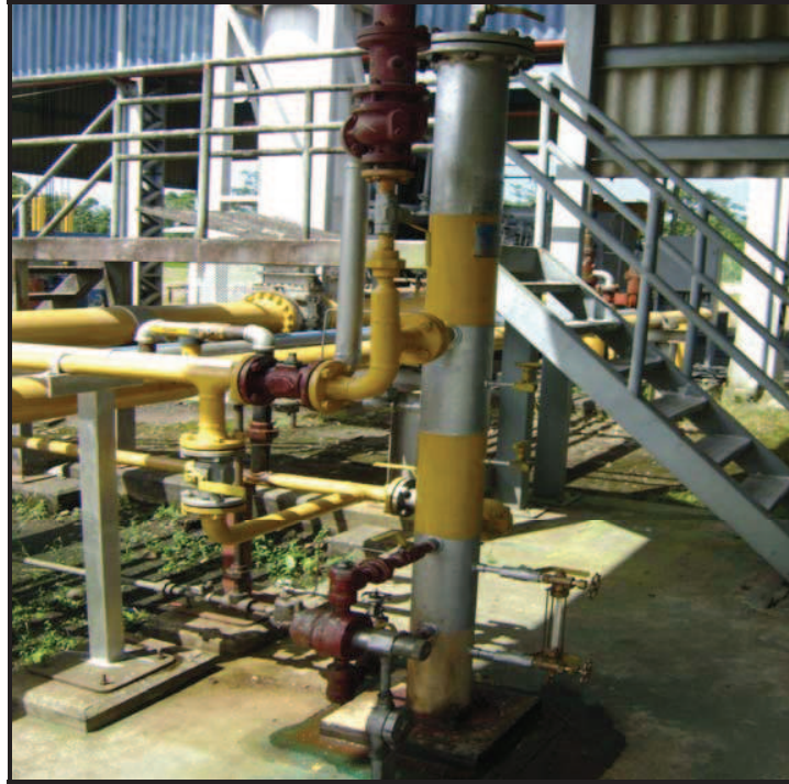
FOTO N°1.13: FILTRO DE COMBUSTIBLE DE GAS FC-01
