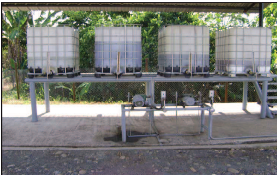
FOTO N° 1.24: SISTEMA DE AIRE DE INSTRUMENTOS
