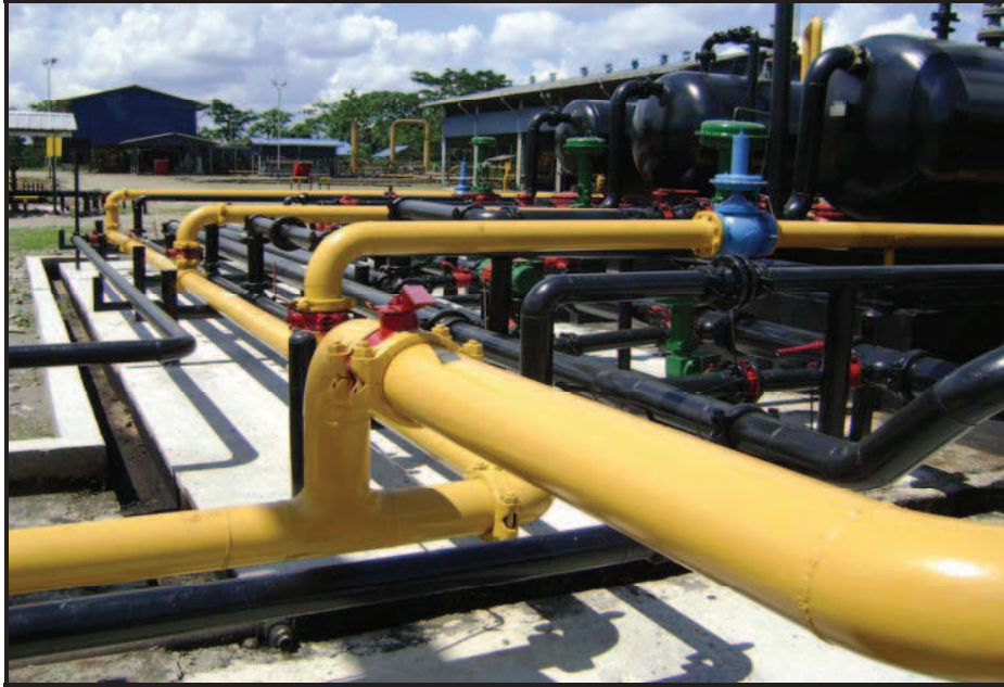
FOTO N°1.3: SALIDA DE FLUIDOS DEL SISTEMA DE SEPARACIÓN
