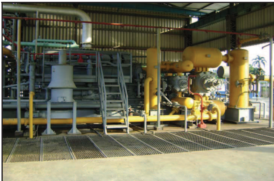
FOTO N°1.14: SISTEMA DE CAPTACIÓN DE GAS
