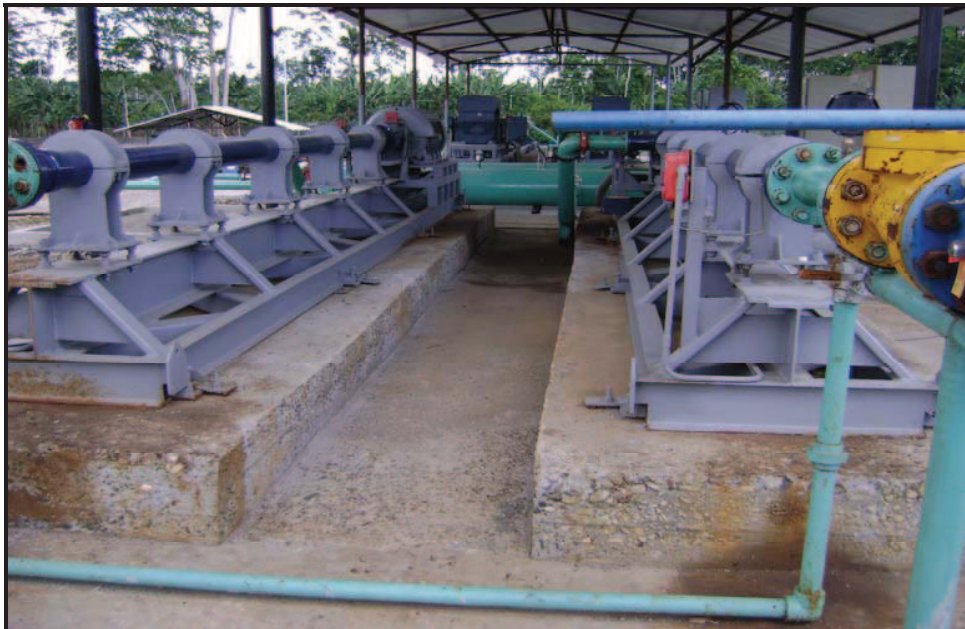
FOTO N°1.18: SISTEMA DE REINYECCIÓN DE AGUA DE FORMACIÓN
