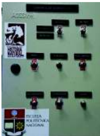
Figura 4.3 Parte delantera del tablero de control del sistema de iluminación
