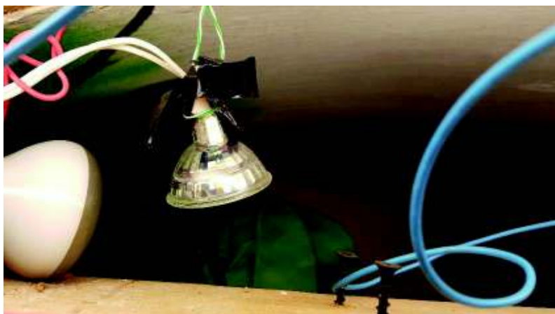
Figura 1.28 Foco sin la boquilla necesaria y conexión eléctrica en pésimo estado
