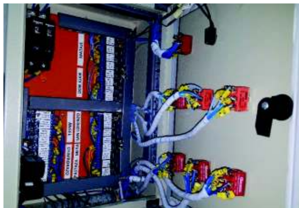
Figura 4.2 Componentes dentro del tablero de control del sistema de iluminación
