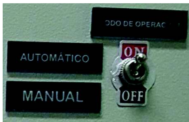
Figura 2.19 Interruptor de modo de operación Manual/Automático
