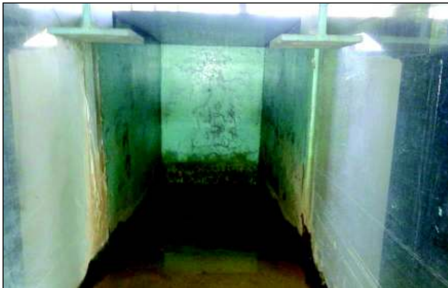
Foto 4. 2 Tanque de uniformización de flujo.
