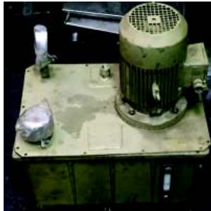
Figura 3.43. Tanque de 33 litros. (Fuente: propia)
