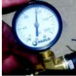
Figura 3.8. Medición del manómetro 115 psi. (Fuente: propia)
