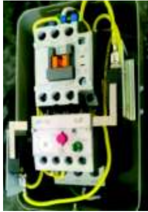
Figura 3.61. Conjunto eléctrico 22AF. (Fuente: propia)
