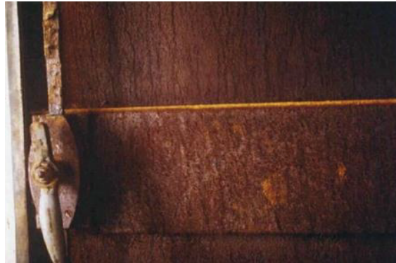
Figura 2.2. Ejemplo de Corrosión Uniforme
