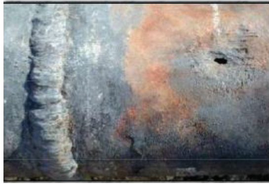
Figura 2.4. Ejemplo de Corrosión por Picaduras
