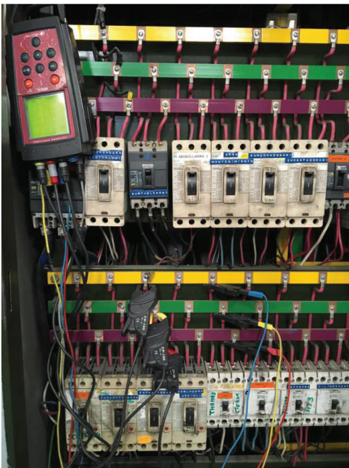
Conexión del medidor al sistema de extracción (Fuente: Elaboración autores)
