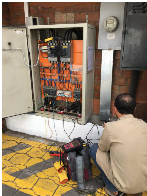
Preparación para mediciones en tablero principal
