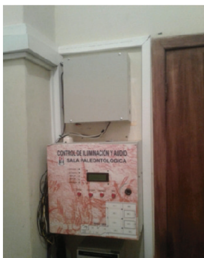
Figura 2.18 Disposición externa de la caja de protección
