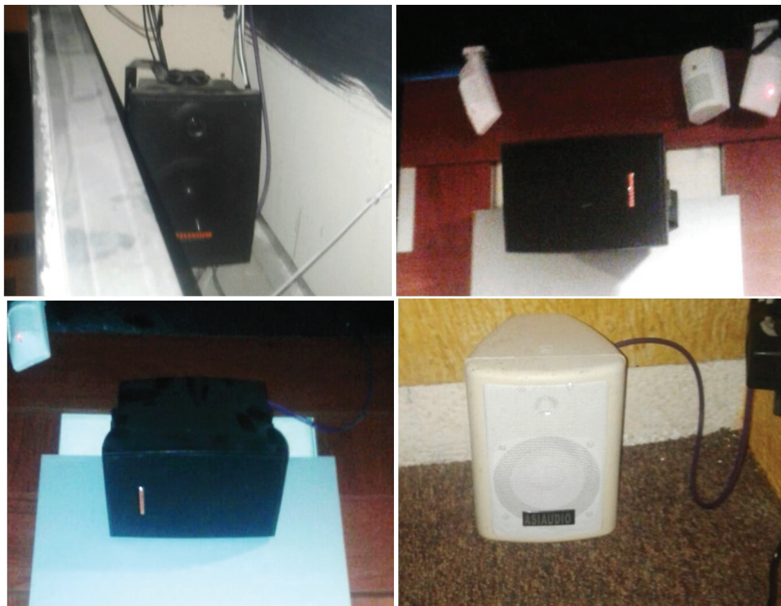
Figura 2.21 Instalación de dispositivos de audio, parlante 1 (sup. izq.), parlante 2 (sup. der.), parlante 3 (inf. izq.), parlante 4 (inf. der.).
