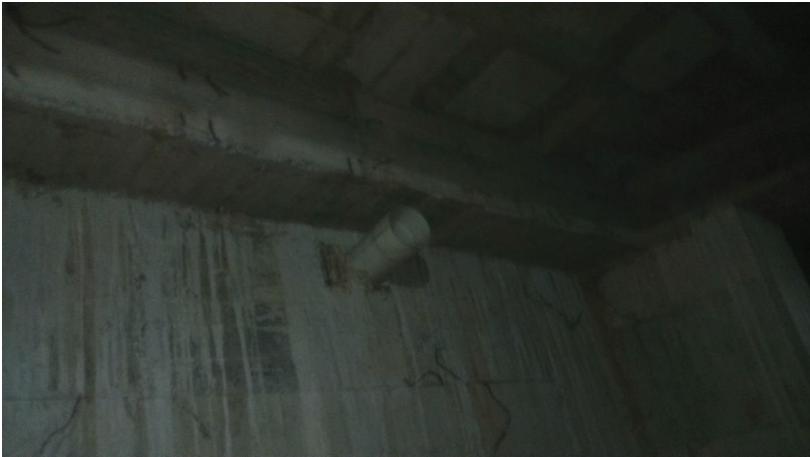
Entrada de servicios de telecomunicaciones.
