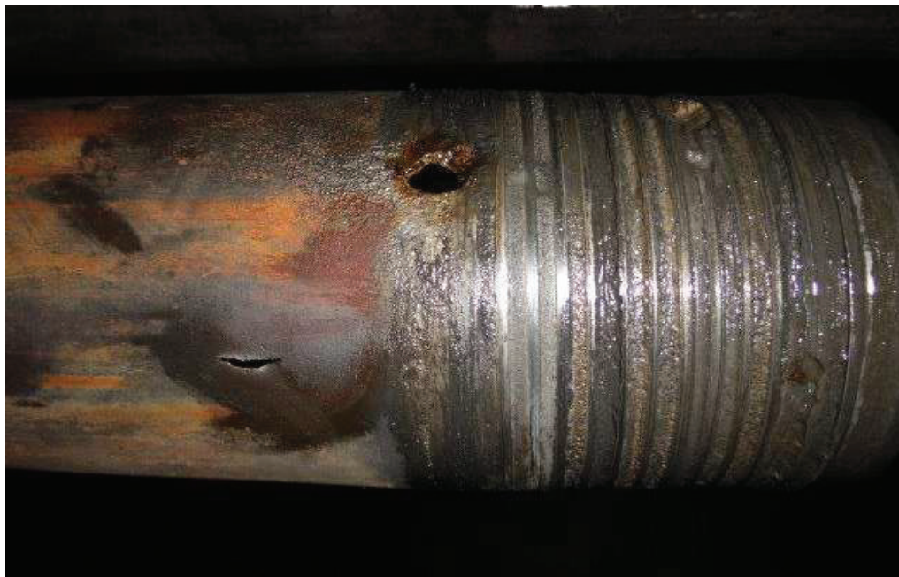
Figura 2.7. Agujero en tubería. Fuente: Tecpetrol, 2017
