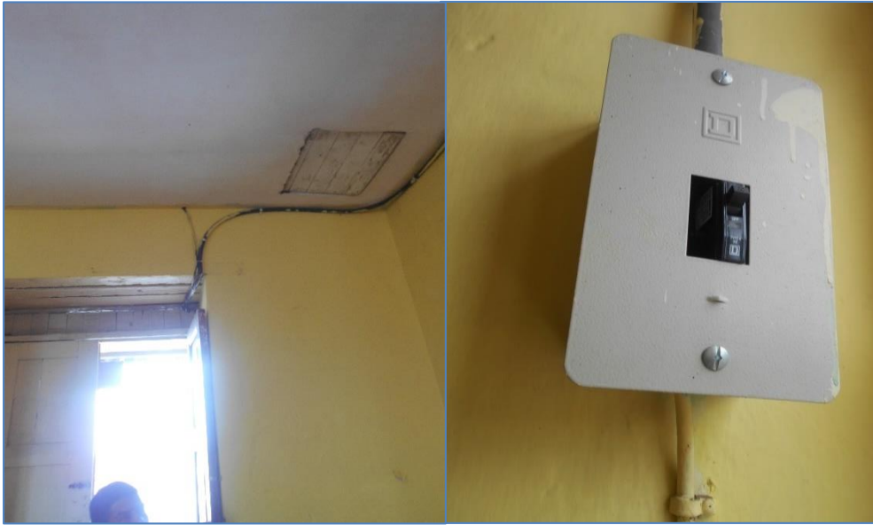
Figura 1.17 Estado de cajas de distribución de aulas del bloque antiguo
