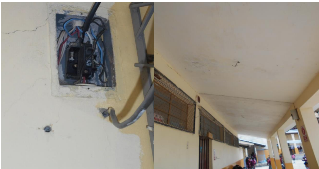
Figura 1.18 Cajas de distribución del bloque de aulas prefabricadas.
