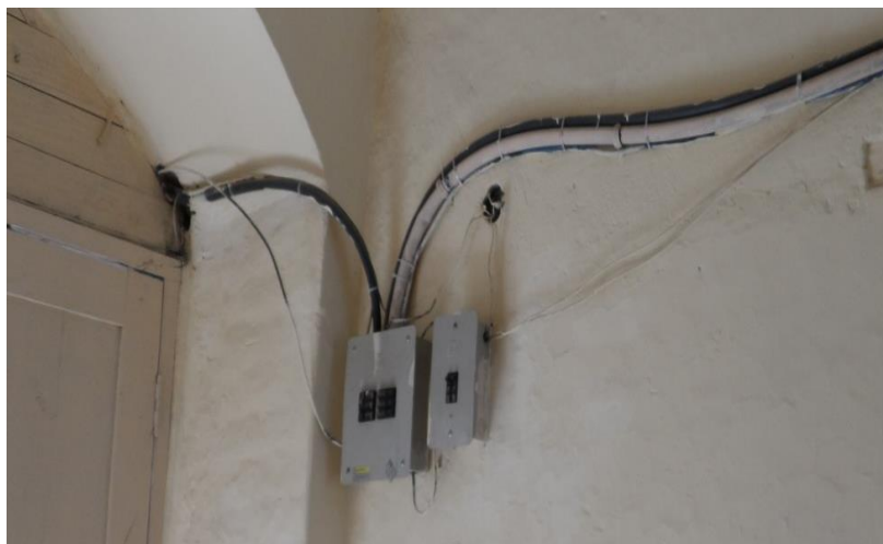
Figura 1.16 Tablero principal de la escuela
