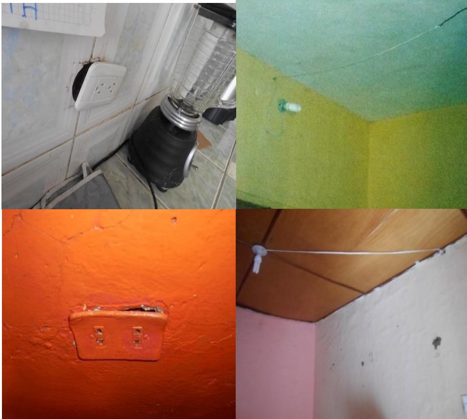
Figura 1.12 Estado actual las instalaciones eléctricas bloque antiguo y cocina
