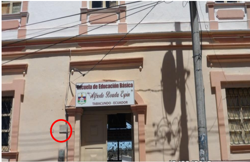
Figura 1.15 Acometida principal de la Escuela Alfredo Boada
