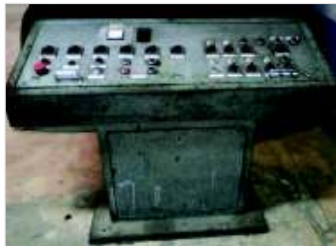
Figura 1.9. Panel de control de mando del sistema eléctrico de máquina
