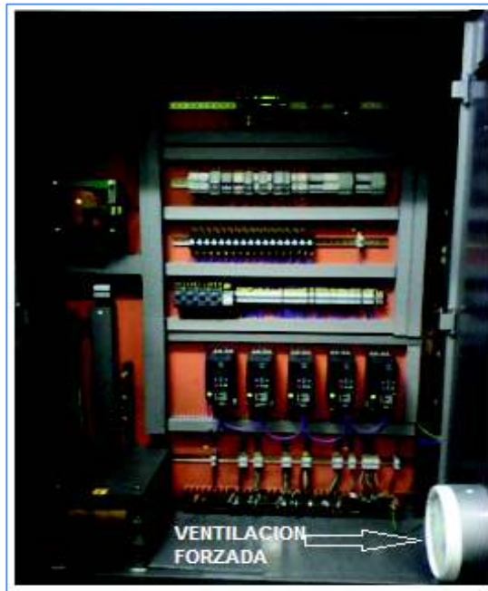
Figura 2.31. Ventilación forzada en el banco de variadores de frecuencia del proyecto implementado
