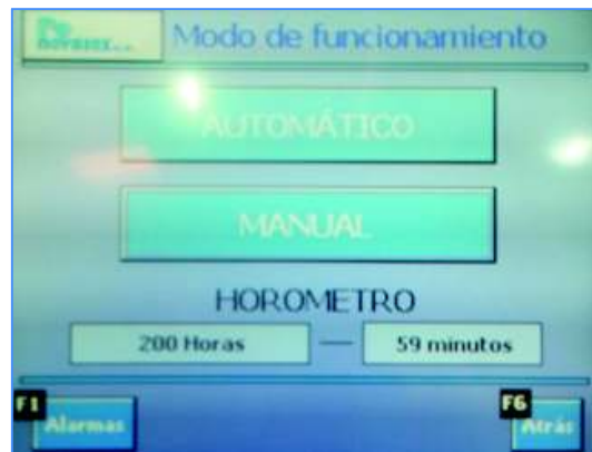
Figura 3.15. Registro de las horas de funcionamiento de la máquina desplegada en la HMI
