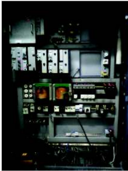
Figura 1.8. Tablero eléctrico 2 del sistema conversor y gobernador de velocidad
