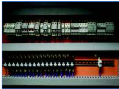
Figura 3.13. Protecciones eléctricas de control en el armario
