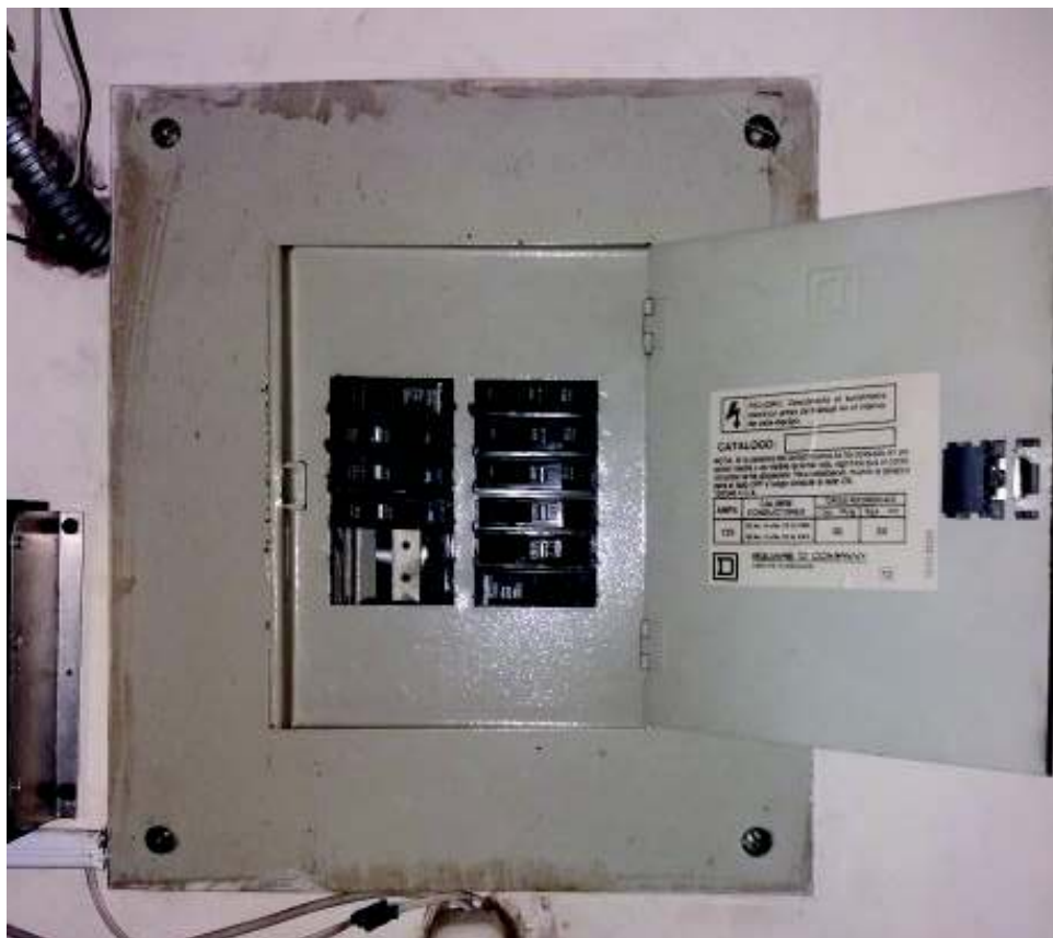
Figura 46: Tablero de alimentación principal
