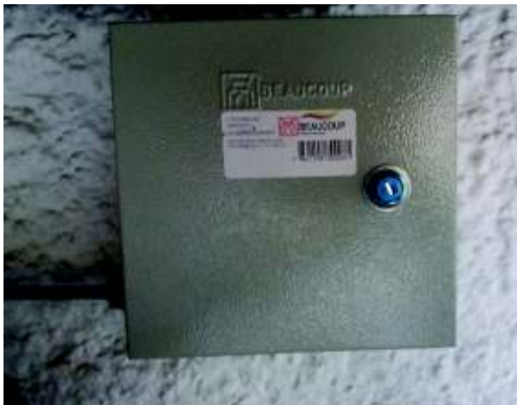
Figura 47: Tablero de alimentación independiente
