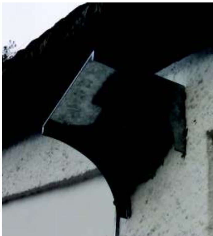
Figura 5: Protección exterior adicional de las luminarias
