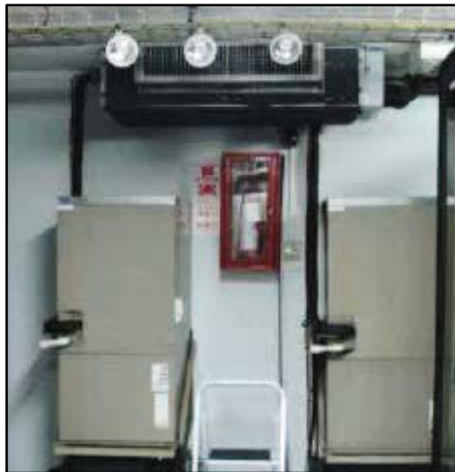
Figura 2.4 Aires acondicionados instalados en un nodo [74]
