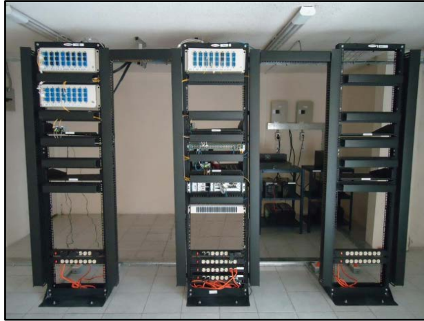
Figura 2.3 Estructura de racks [74]
