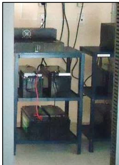
Figura 2.6 Banco de baterías en serie [74]
