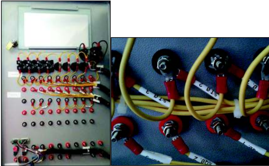
Figura 3.23 Cableado interno de los componentes.
