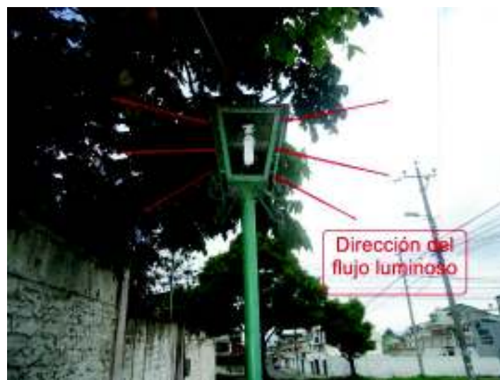
Figura 5.3. Luminarias ornamentales en la calle E3D Luis Banderas.
