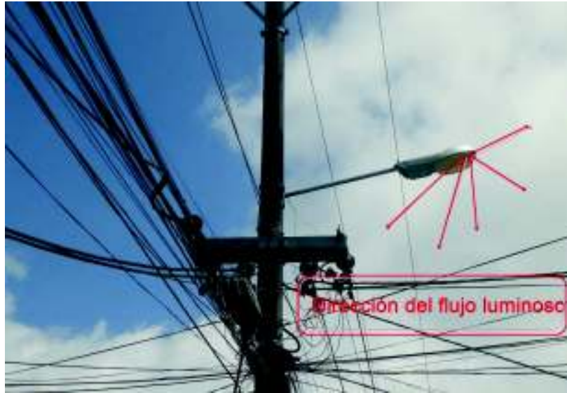
Figura 5.1. Luminaria ubicada en la calle N49 Aparicio Rivadeneira.
