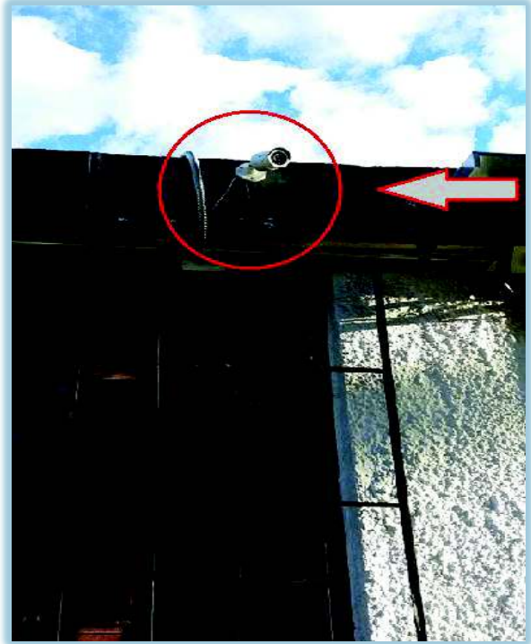
Figura 24 Cámara instalada bosque vista norte
