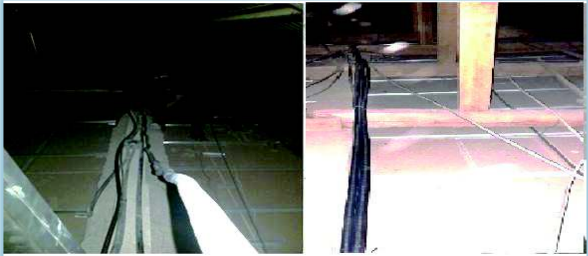
Figura 15 Tubería incrustada sobre cielo falso
