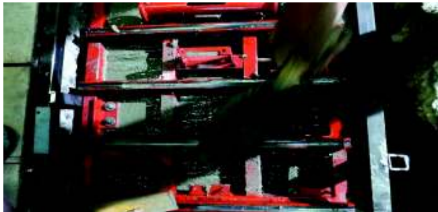
Figura 3.63. Relleno de concreto del fondo y paredes laterales de la fosa Fuente: Propia
