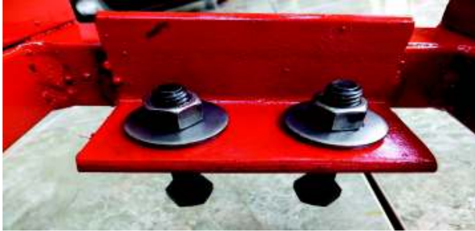
Figura 3.60. Anclaje de la estructura del equipo, con 8 pernos M10X 50mm de longitud Fuente: Propia
