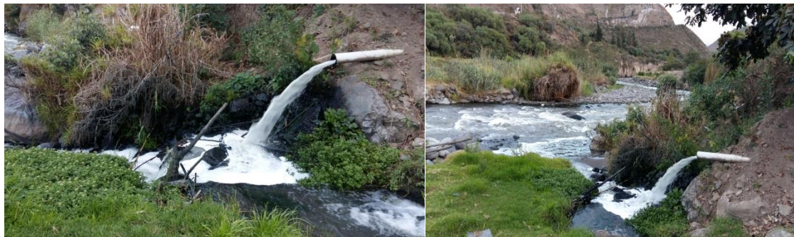
Aguas residuales proveniente de las lavanderías y tintorerías de jean y enviada al río Patate (20/06/2017).
