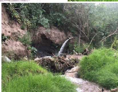
Tubería colapsado en el sector el puente que une con el rio Patate (10/06/2017).
