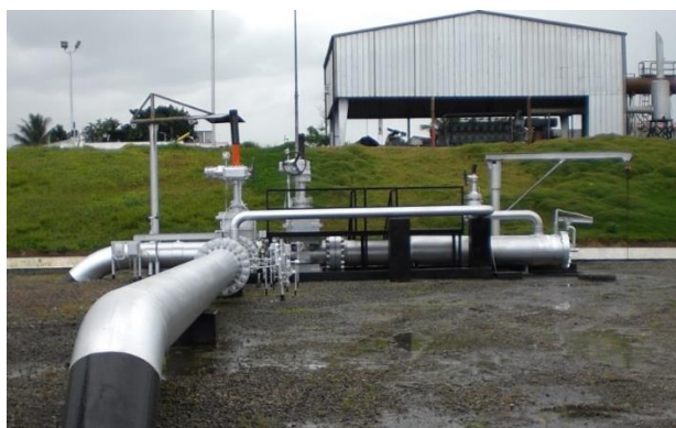
Figura 1.15. Trampa lanzadora de raspadores. Fuente: Estación Lago Agrio SOTE EP Petroecuador.
