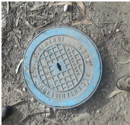
FIGURA 44: TAPA DE LAS VÁLVULAS DE AIRE
