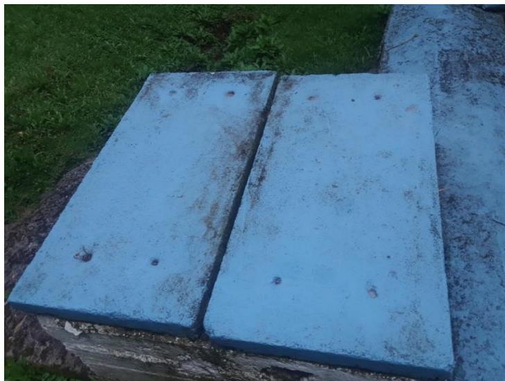
FIGURA 32: VÁLVULA DE DESAGUE FUERA DE USO
