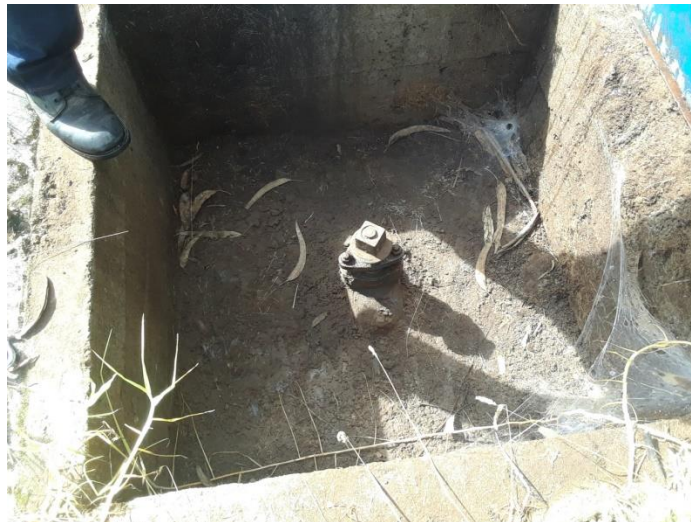
FIGURA 45: VÁLVULAS DE AIRE FUERA DE USO
