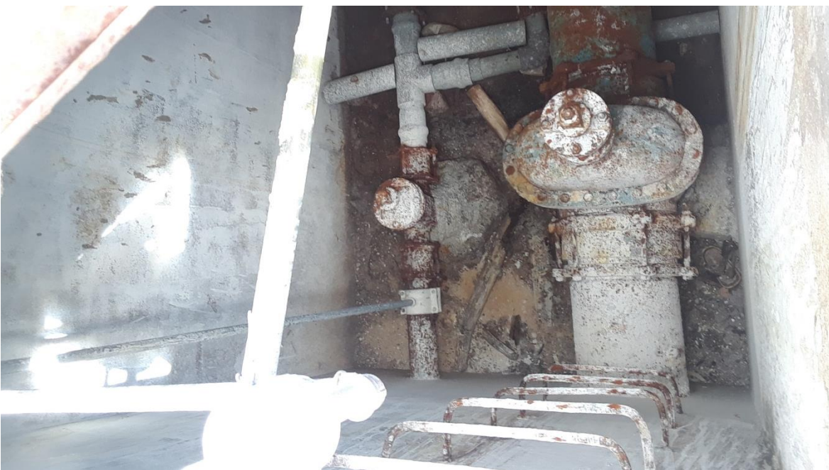
FIGURA 52: TUBERÍA DISTRIBUCIÓN DE AGUA BARRIO LORETO
