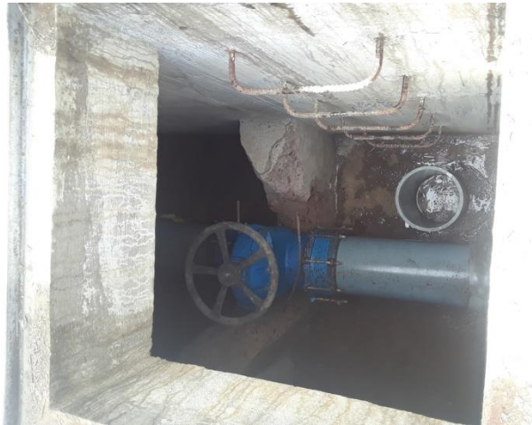
FIGURA 47: VÁLVULAS DE CONTROL
