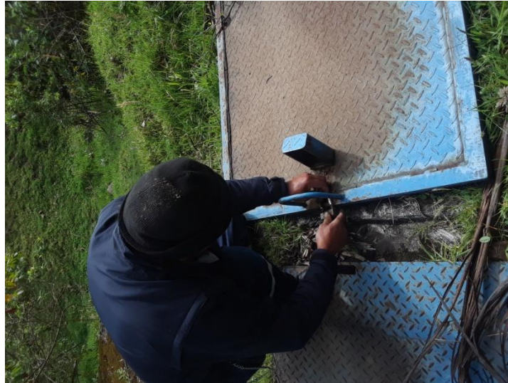
FIGURA 46: CAJA DE LAS VÁLVULAS DE AIRE
