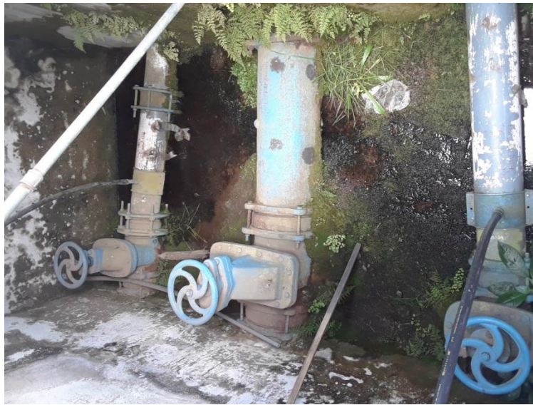
FIGURA 54: TUBERÍAS DE DISTRIBUCIÓN DE AGUA
