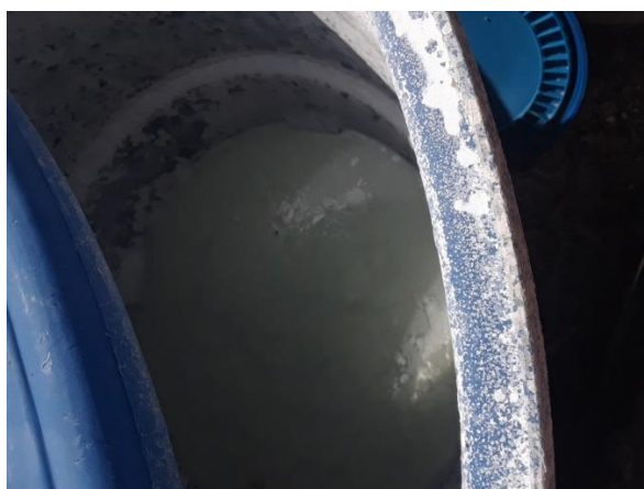
FIGURA 49: TANQUE DE CLORACIÓN
