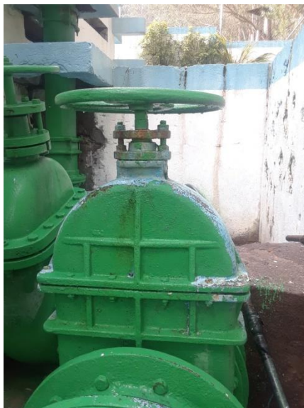
FIGURA 35: VÁLVULA DE DESAGUE
