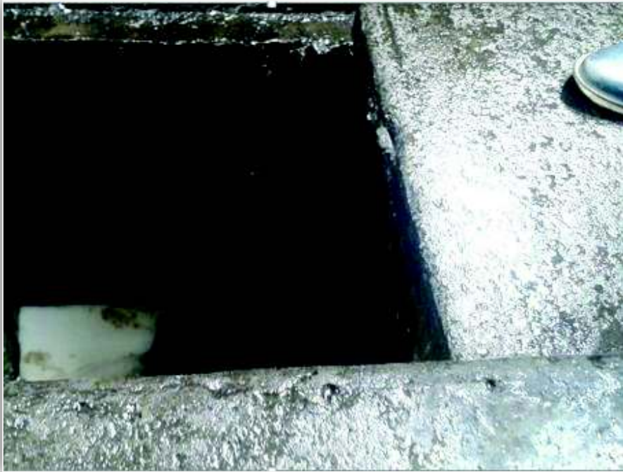
Figura 8 Pozo colector de aguas residuales
