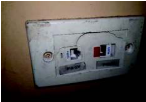
Figura 3.1 Punto instalado deteriorado
