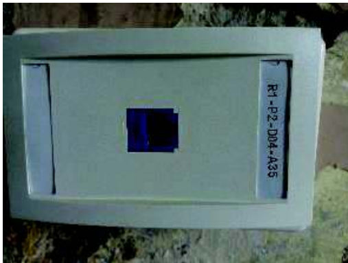
Figura 3.26 Terminación del punto de red
