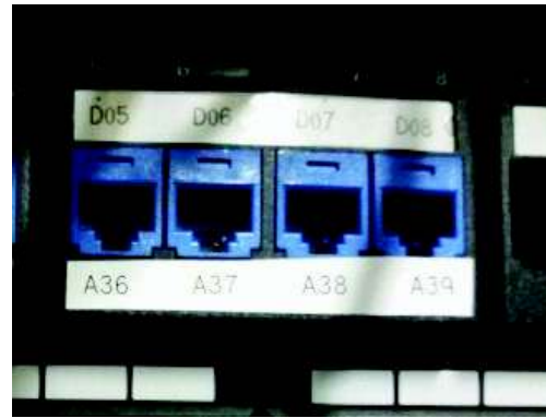
Figura 3.27 Instalación de jack en patch panel
