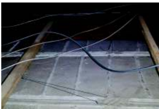
Figura 3.3 Instalaciones de cableado de la ESFOT
