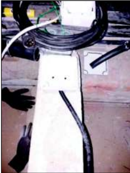
Figura 3.12 Caja de paso o de distribución
