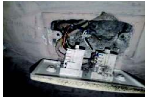
Figura 3.2 Punto de red deteriorado
