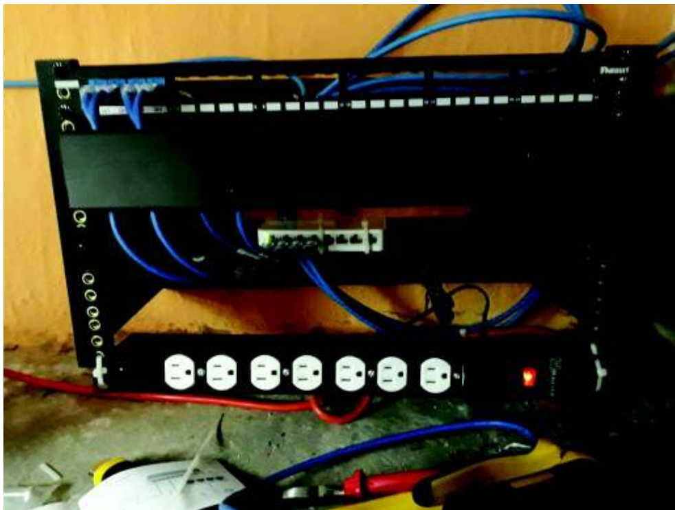
Anexo 8.10 Rack instalado oficina 5
