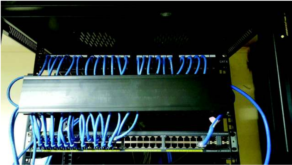
Anexo 8.11 Peinado de Cables UTP en rack de Lab. 22
