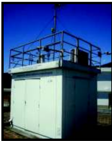
Figura 3. 1. Infraestructura externa de la estación meteorológica de Belisario. (Fuente: Propia)
