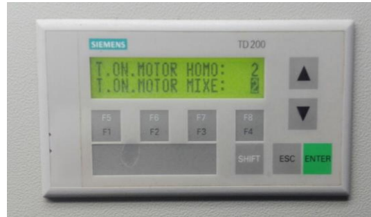
Figura 3.2. Tiempos establecidos para encendido de motores.
