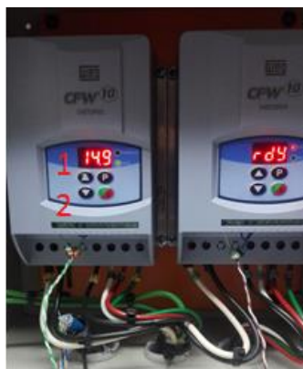
Figura 4.4. Variadores de frecuencia WEQ, tablero TCV.
