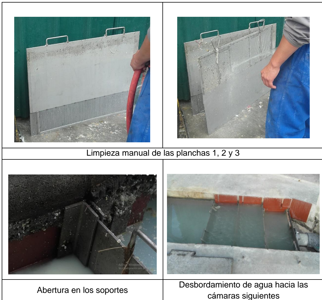
Figura 8. Diseño de las planchas, limpieza manual, aberturas en los soportes y desbordamiento de agua
