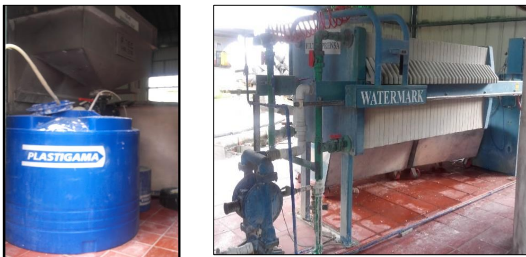
Figura 12. Tanque de espesamiento de lodos y filtro prensa
