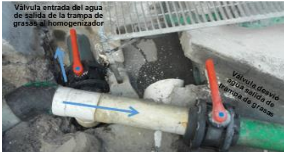
Tubería de PVC y válvula de entrada de agua al tanque de homogenización
