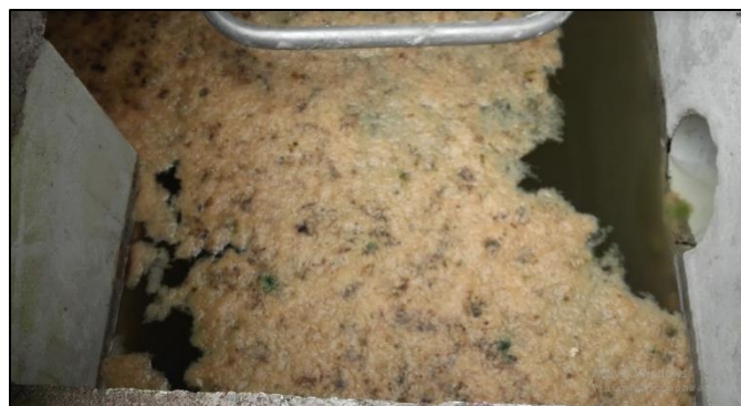
Figura 16. Acumulación de lodos en el tanque de cloración
