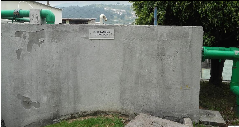
Figura 15. Tanque de cloración
