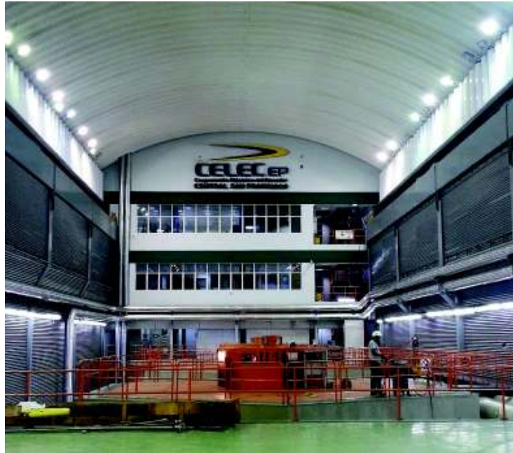
Figura 1.3. Central San Francisco, casa de máquinas. (Fuente: Propia)
