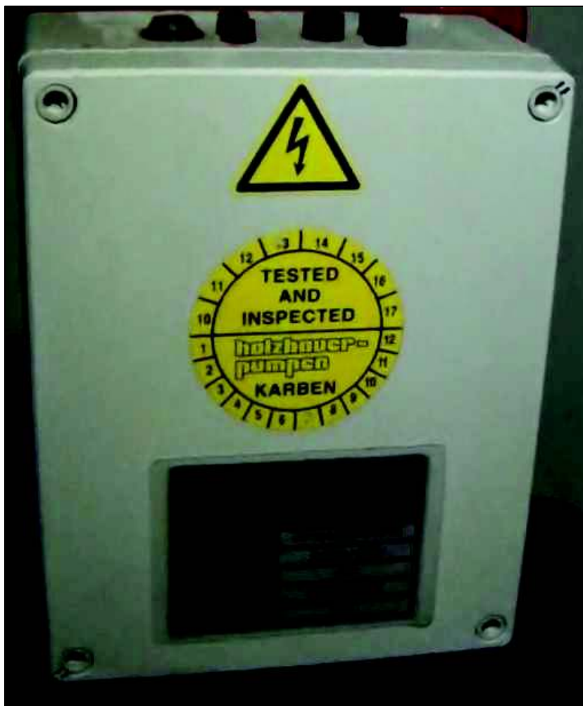
Figura 2.23. Cuadro de Control Eléctrico Bomba Jockey. (Autor)
