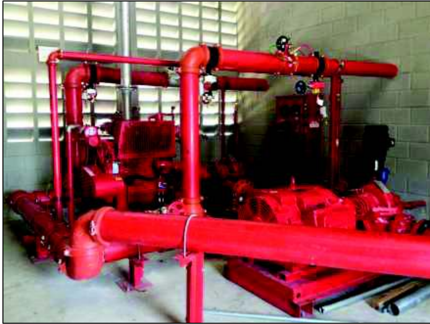
Figura 1.22. Casa de Bombas. (TECNI-TIPS-GANB, 2014)
