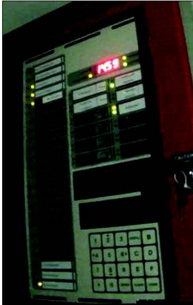
Figura 2.24. Panel de Alarma Contra Incendios. (Autor)
