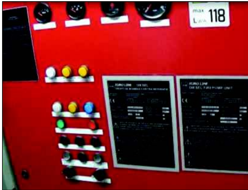
Figura 2.15. Tablero de Control de Motor de Combustión Interna. (Autor)
