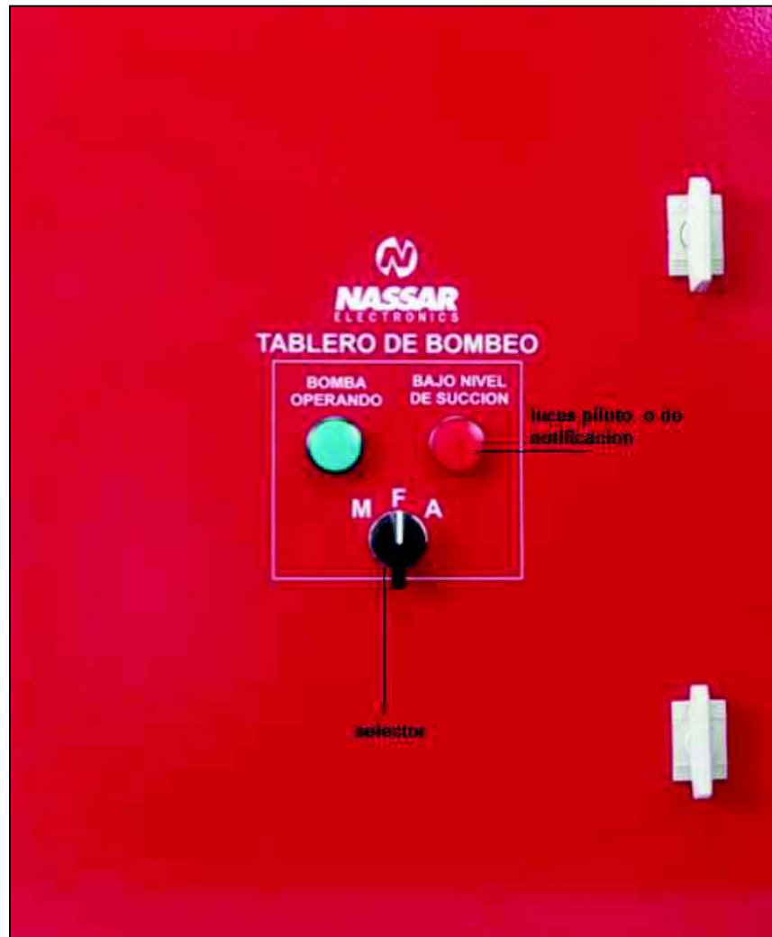
Figura 2.14. Tablero de Control Para un Motor Eléctrico. (Autor)
