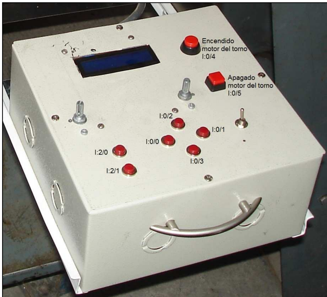
Figura 3-18. Pulsadores utilizados en el tablero de control
