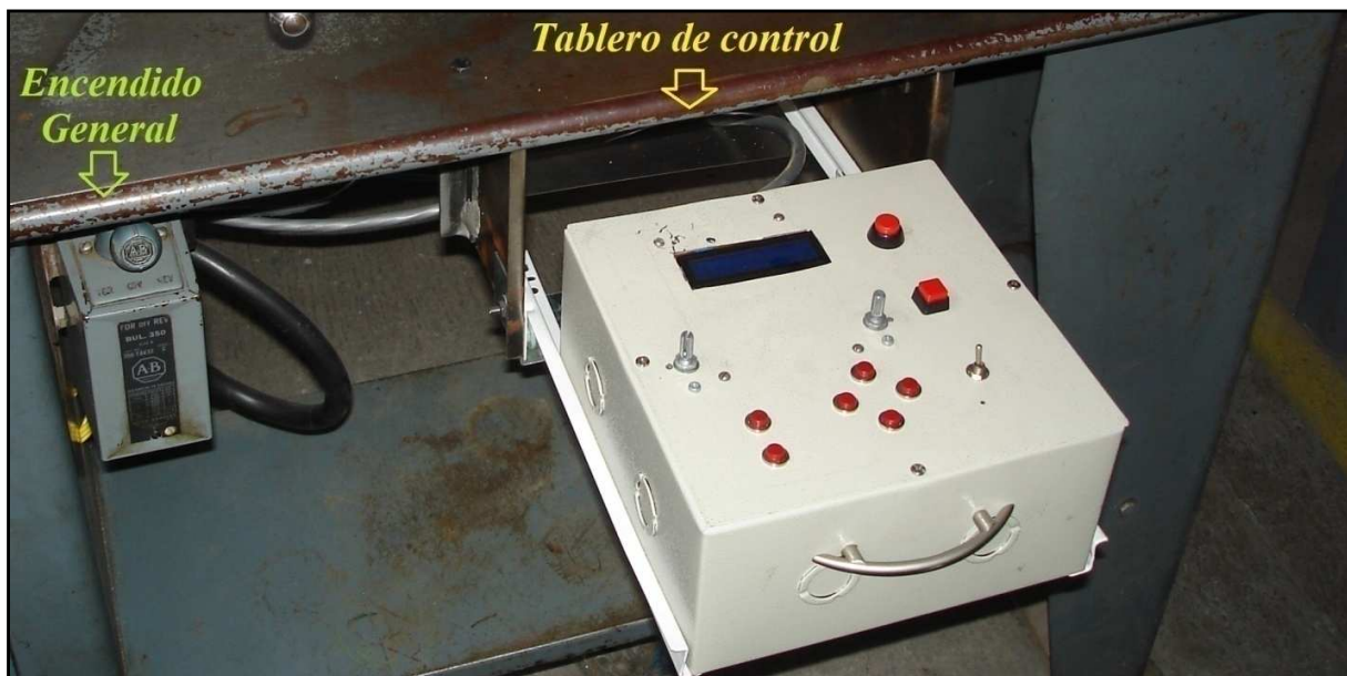
Figura 3-15. Encendido general y tablero de control
