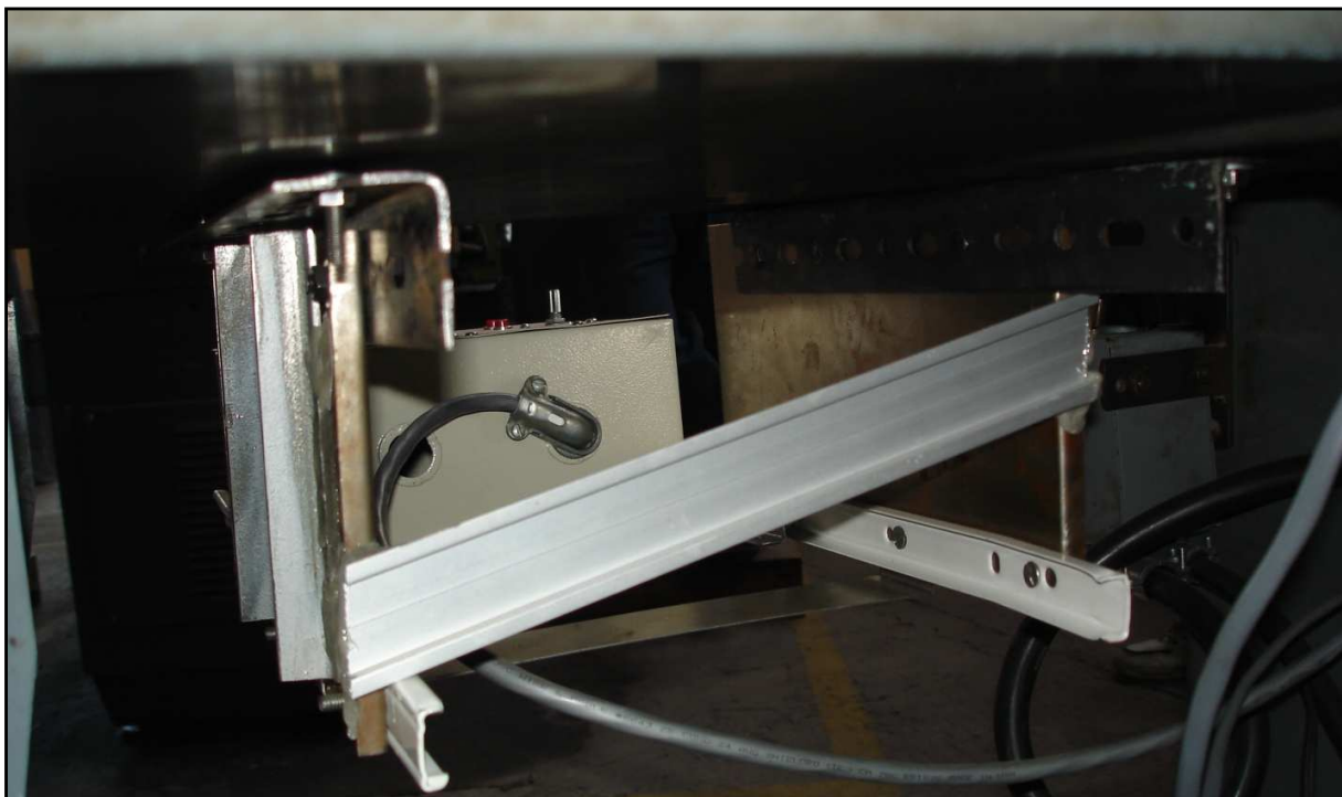
Figura 3-17. Estructura de soporte del tablero de control
