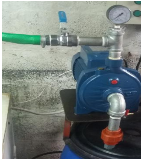
Figura 69. Instalación hidráulica en bomba de llenado (Burbano, Oña)
