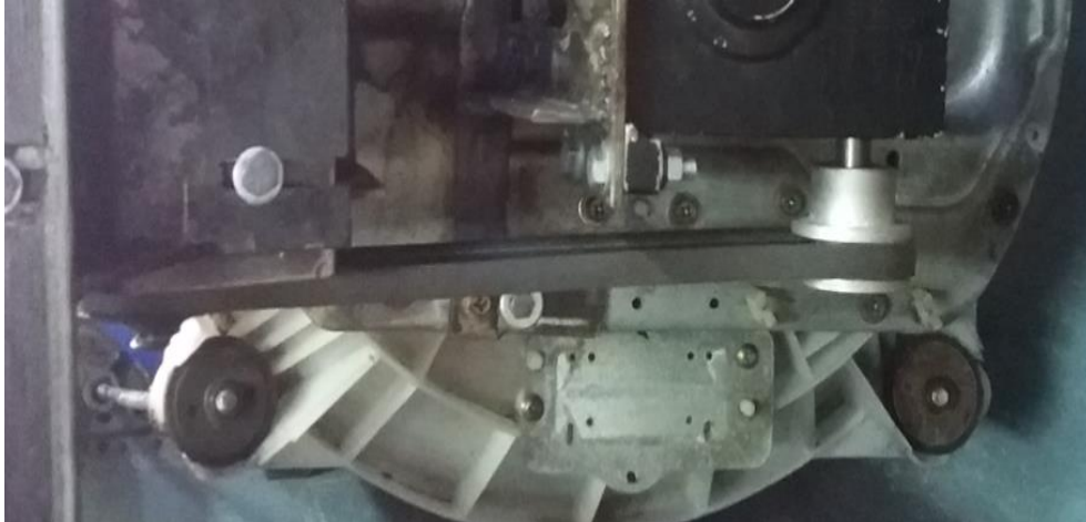
Figura 60. Acoplamiento de motor eléctrico con reductor mecánico (Burbano, Oña)
