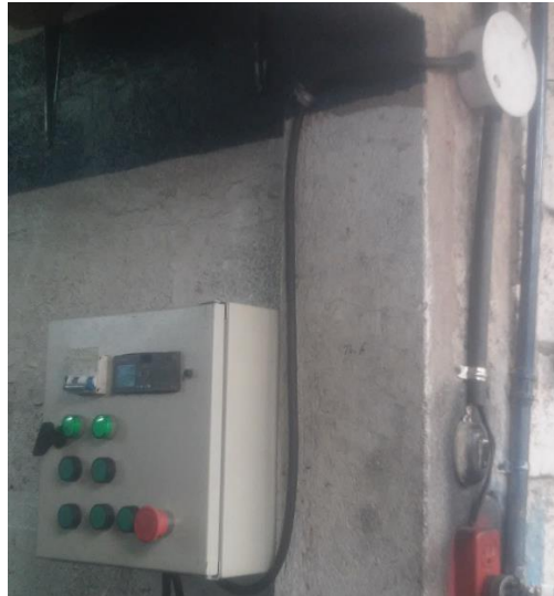
Figura 80. Cableado de alimentación principal (Burbano, Oña)
