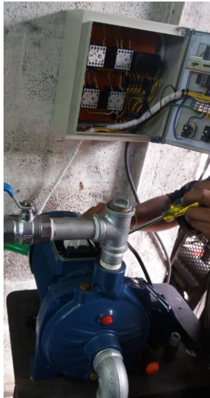
Figura 79. Conexión de equipos (Burbano, Oña)
