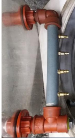
Figura 72. Tubería con boquillas de aspersión (Burbano, Oña)
