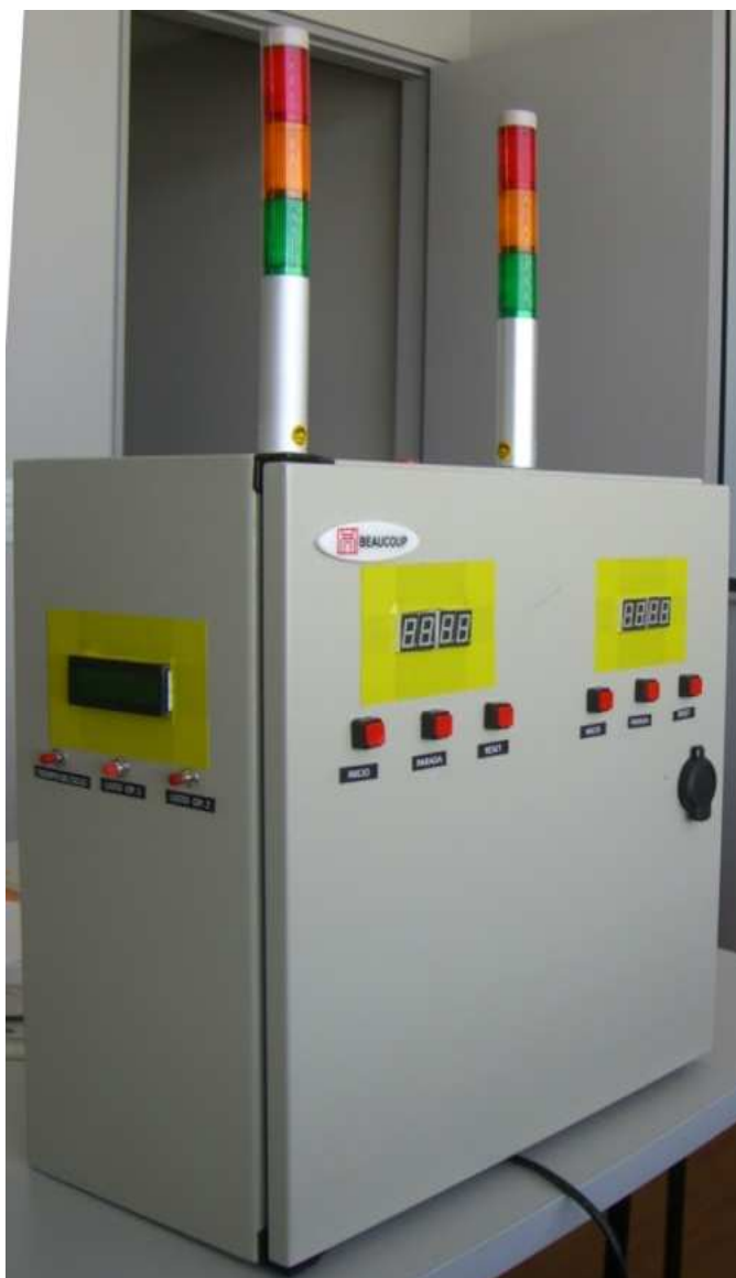
Figura 4.10. Vista del tablero
