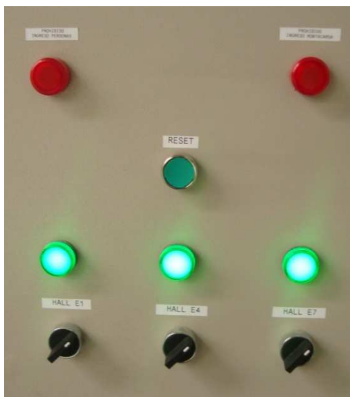
Figura 2.9. Luces piloto, selectores y pulsador del tablero.
