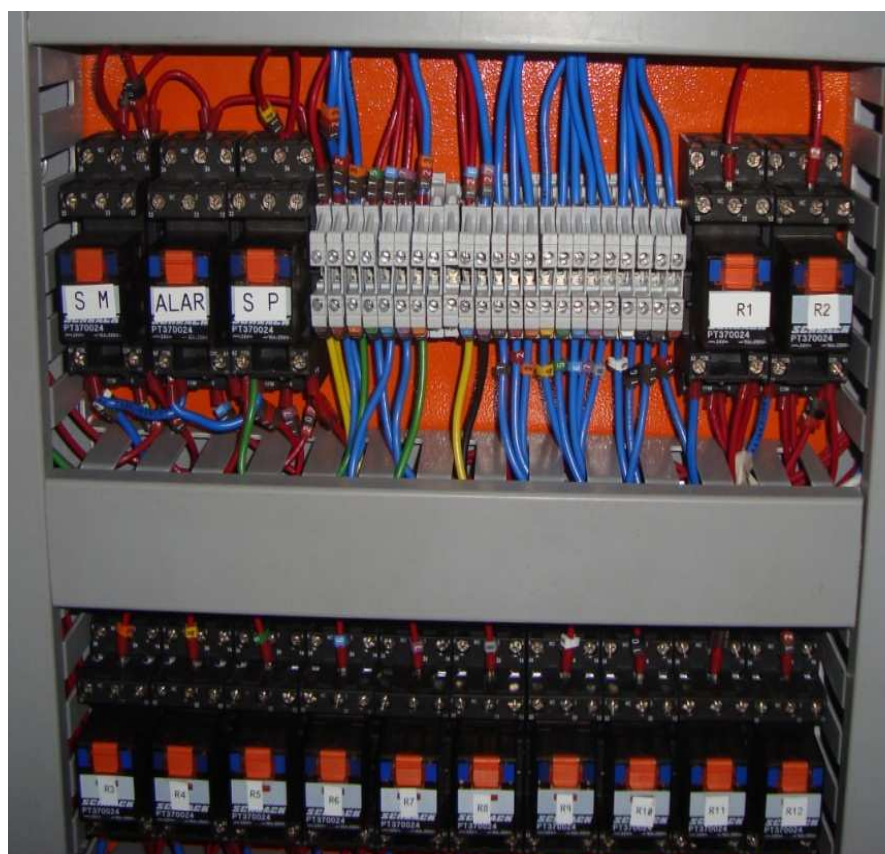
Figura 2.8. Relés en el tablero de control
