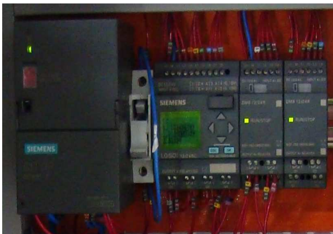
Figura 2.6. Sistema controlador instalado
