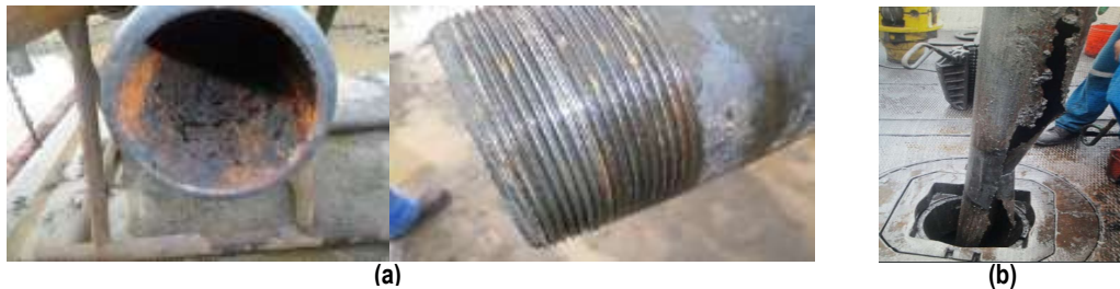
Figura 4.15. (a) Presencia de corrosión al interior de la tubería; reportado en la extracción de la tubería del pozo YCAC-007 WO#19. (b) Presencia de corrosión severa; reportado en la extracción de la tubería del pozo YCAC-007 WO#20.
