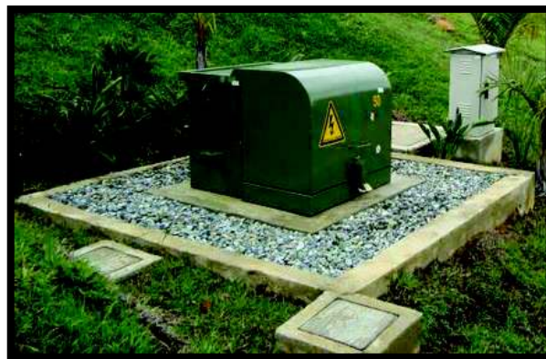
Figura 2.3 Transformador tipo pedestal
