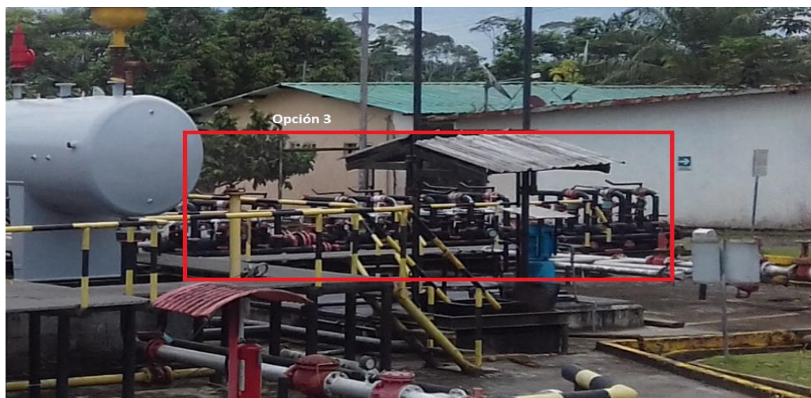
Figura 2.5. Área del manifold de producción
