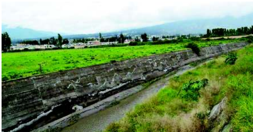
Figura 2. 9 Canales para escorrentías aún no están terminados (La Hora, 2017).
