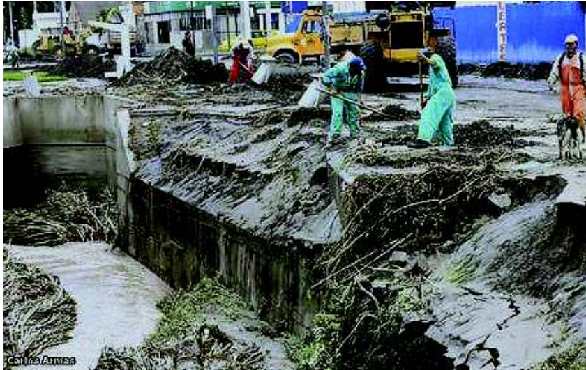
Figura 1. 2 Trabajadores municipales limpiando los escombros que dejó la inundación por el desbordamiento del río-colector Ajaví. (El Universo, 2011).
