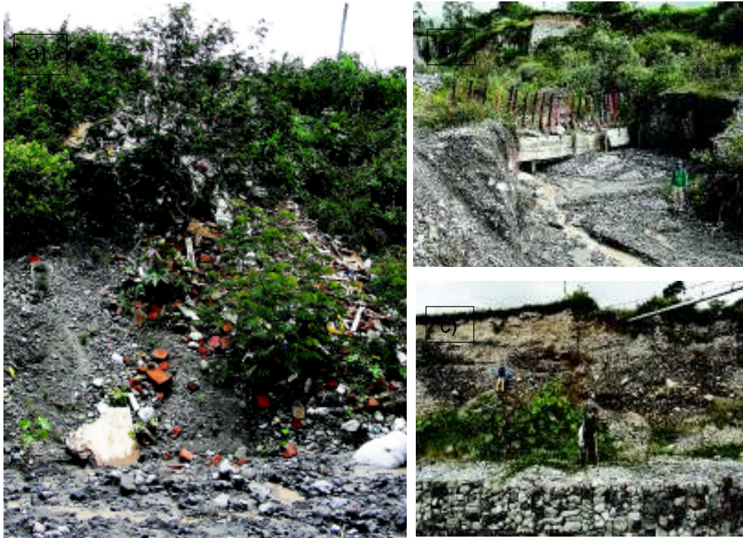
Figura 5. 2 En a) se muestra un botadero de ladrillos y escombros; b) estructura llamada “peinilla” que ha colapsado por falta de mantenimiento; c) un microdique y una tubería que cruza la quebrada Seca.
