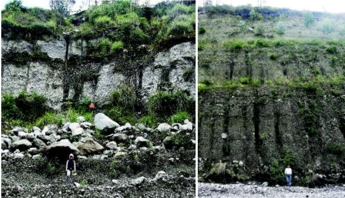
Figura 5. 1 Desgaste de taludes en áreas de canteras. Der. Cantera inactiva – Qda. Seca. Izq. Cantera activa Terraza Quebrada Blanca 2 – Qda. Las Flores.
