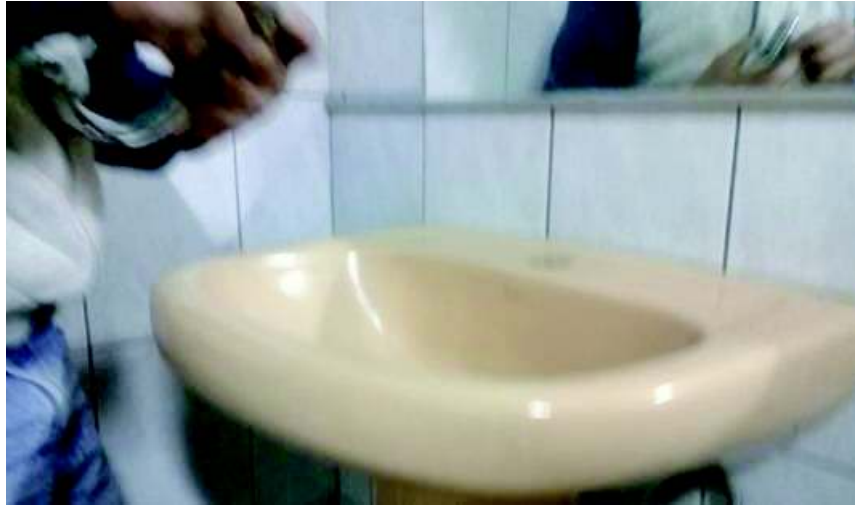
Ilustración 57 Intercambio de grifos de los lavamanos.
