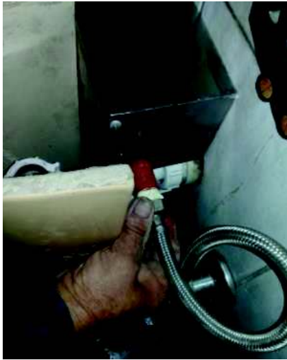
Ilustración 64 unión de las mangueras a la electroválvula.
