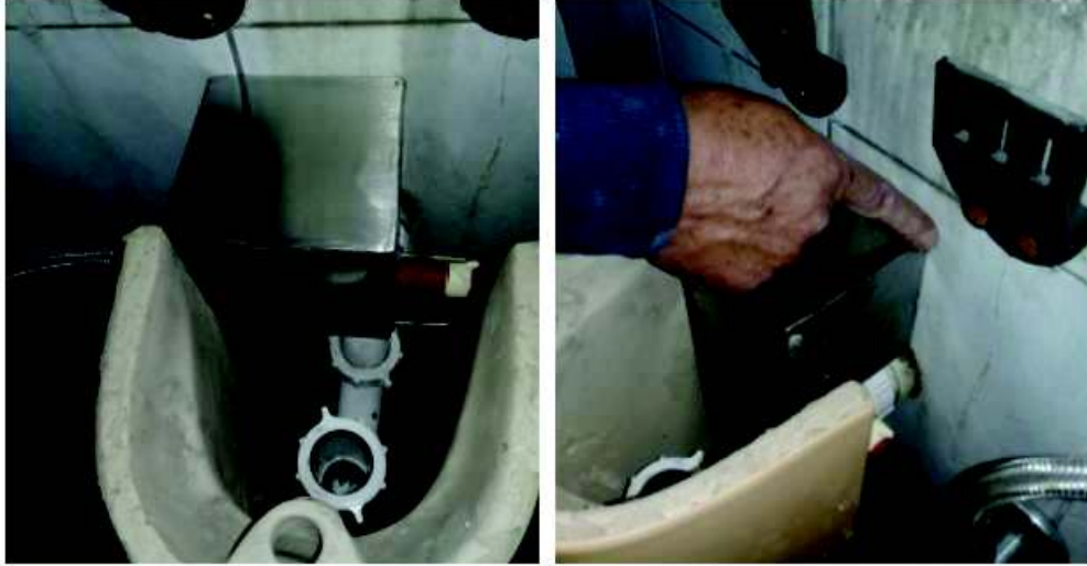
Ilustración 63 Ubicación de la electroválvula y su caja protectora.
