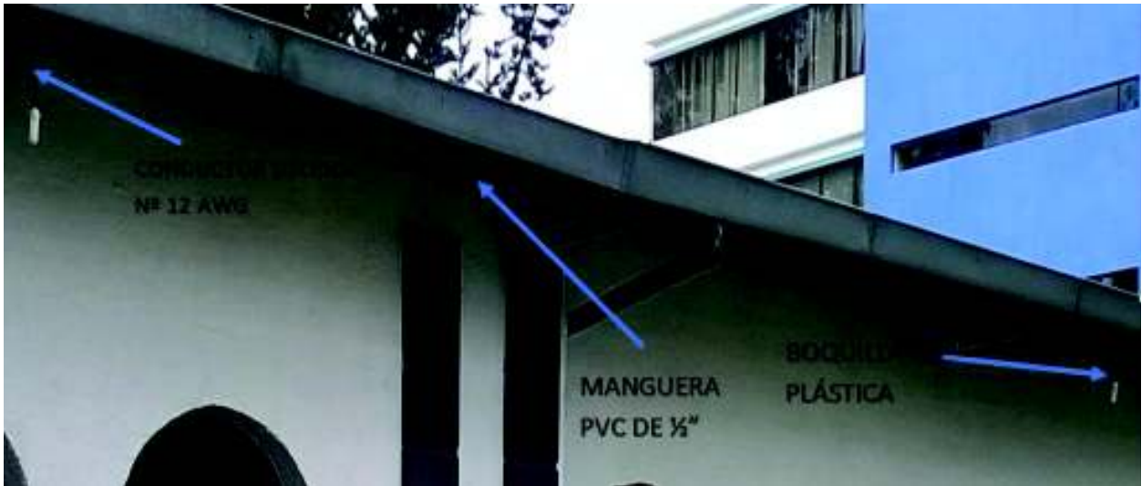
Figura 2.2. Sistema eléctrico antiguo Fuente: Propia
