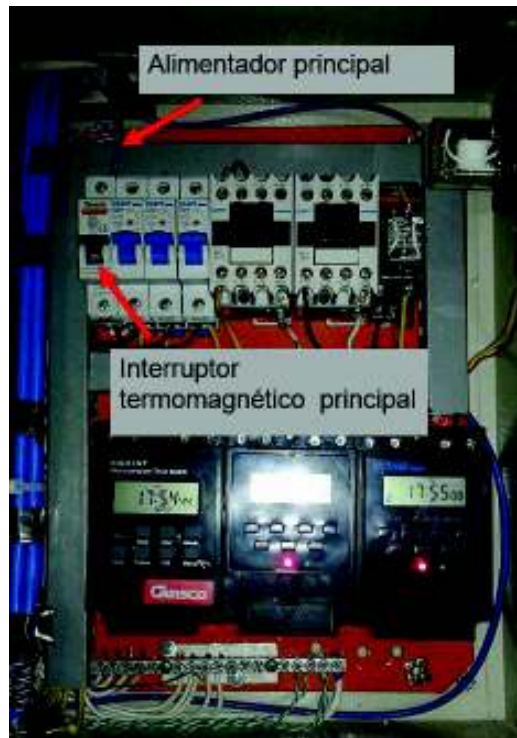
Figura 3.22. Conexión del tablero de control de iluminación exterior Fuente: Propia
