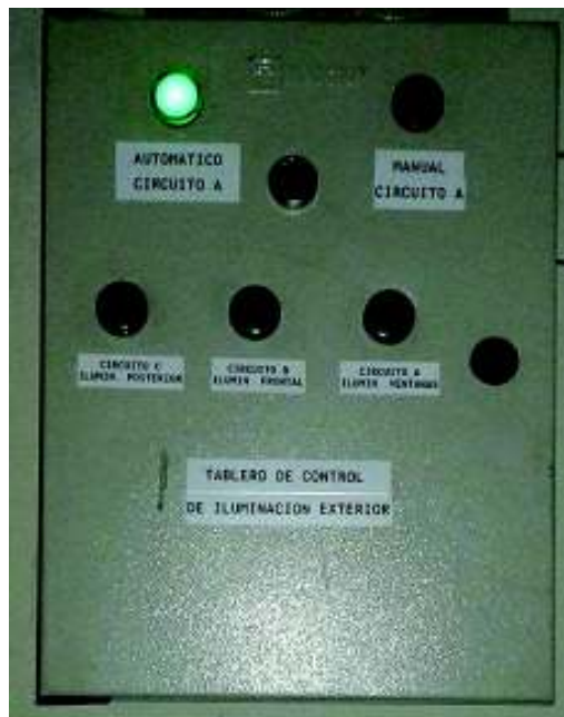
Figura 3.23. Puerta exterior del tablero Fuente: Propia
