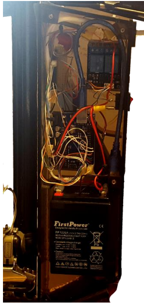
Figura 2.72. Caja de control y sus elementos. (Fuente: Propia)
