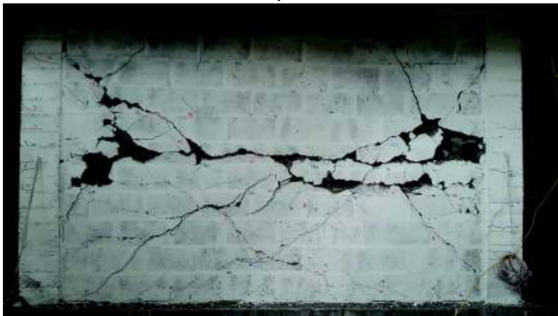
FIGURA 5.24: Pórtico C al final del ensayo:
