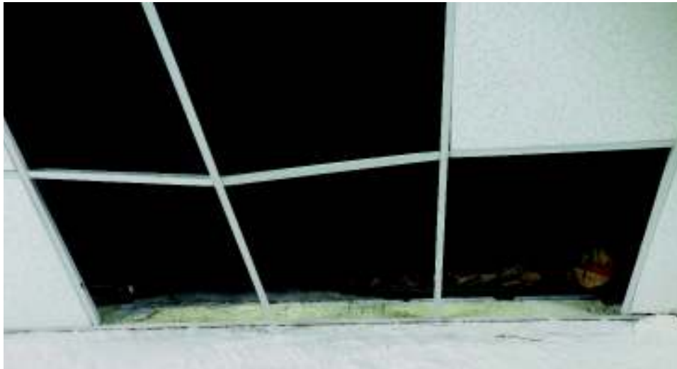
Fotografía 1 Incompatibilidad de materiales en el tercer nivel del edificio FIGP
