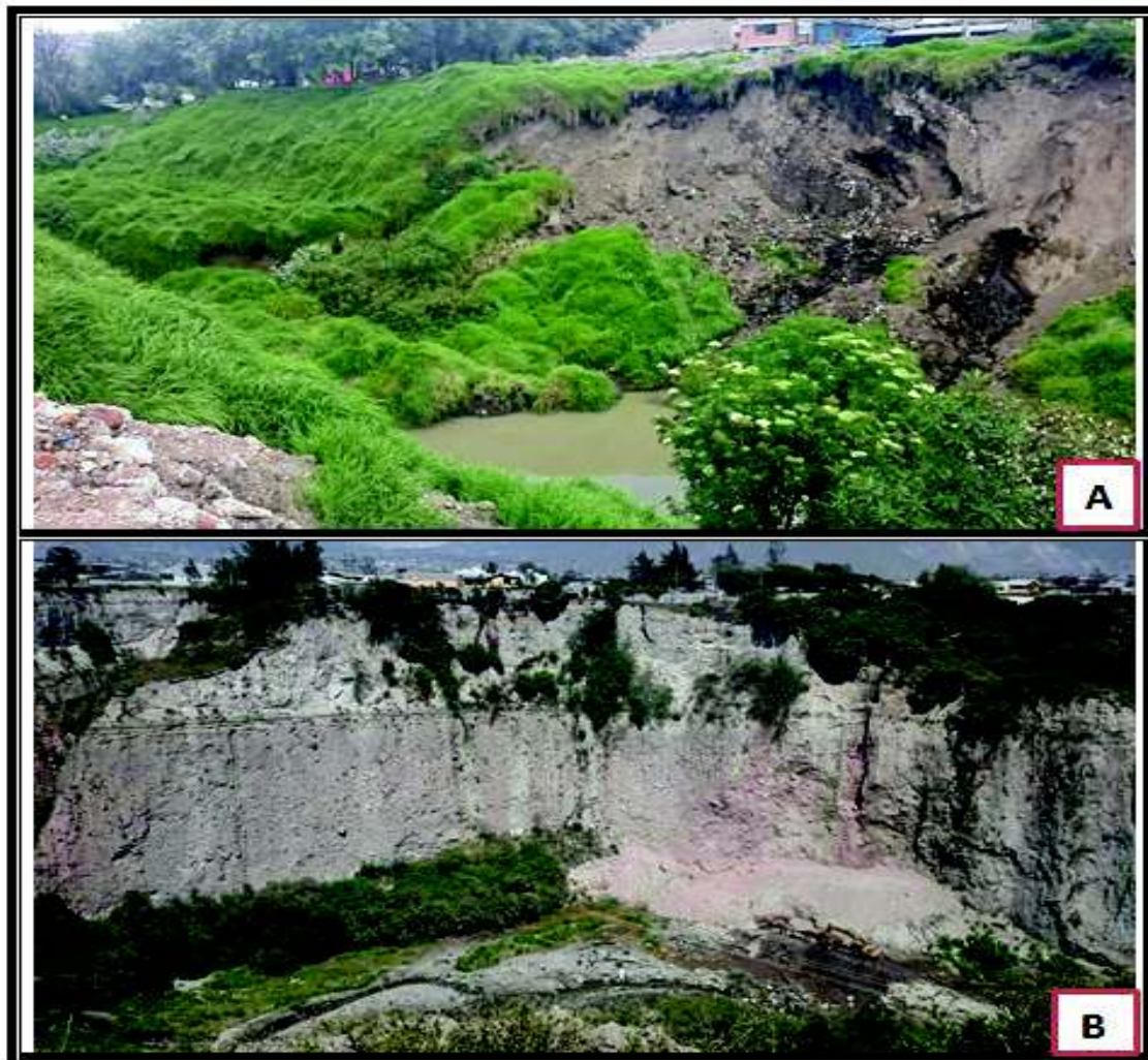
Figura 0.2 A) Deslizamiento en la Quebrada Calicanto debido a los rellenos. B) Deslizamiento en la cuenca del Río Monjas
