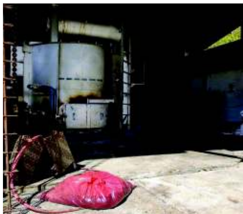
Figura 23. Incinerador (FUEL & GUALOTUÑA, 2018).
