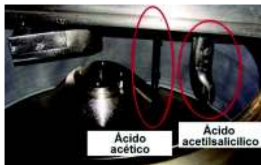
Figura 2.37. Tuberías de ingreso de ácido acético y tubería de ingreso de ácido acetilsalicílico en la canasta de la centrifugadora.
