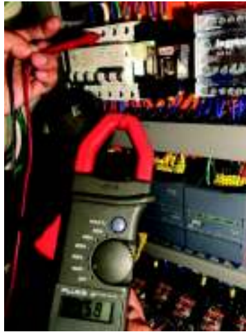
Figura 3.3. Mediciones de voltaje realizadas en la entrada de los circuitos.
