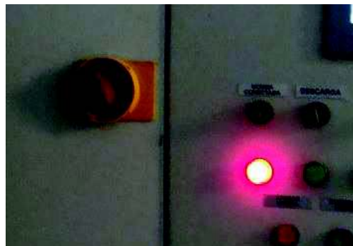
Figura 2.41. Interruptor de seccionamiento de alimentación.
