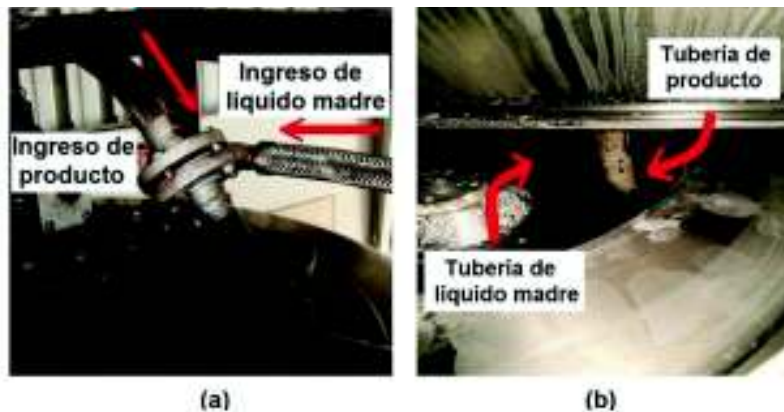
Figura 3.17. (a) Líneas de ingreso de producto y líquido madre. (b) Tuberías de ingreso de ácido acético y ácido acetilsalicílico a la canasta.
