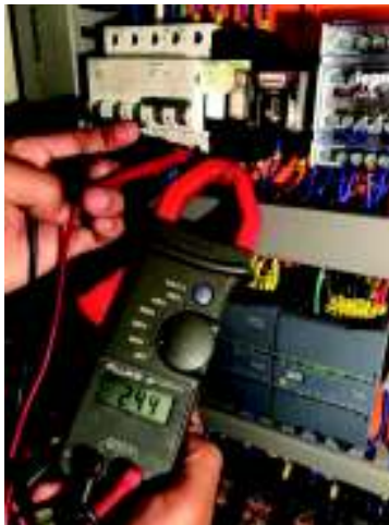
Figura 3.4. Medición de voltaje realizada en la entrada del circuito de control.
