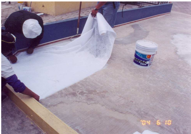
Foto N°24.- Forma de colocación de la malla SÚPER REFUERZO, en cubierta de residencia s/n.
