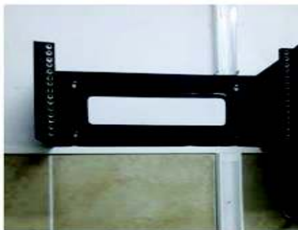
Figura 21. Instalación del rack (Fuente Propia)
