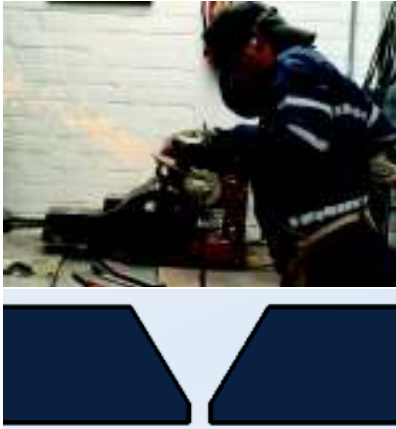
Figura 2.4. Obtención del bisel en V con un ángulo de ranura de 60°. (Fuente: Propia)
