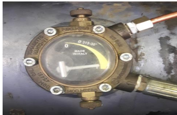
Figura 2.4. Válvula de abastecimiento de GLP. (Fuente: Propia)
