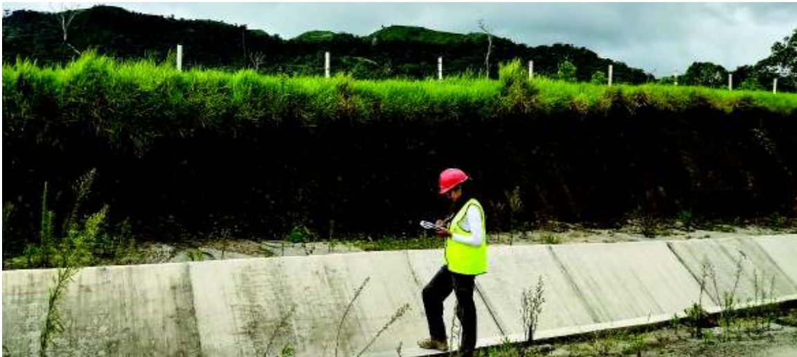
Fotografía 4.17 Deslizamiento D-006. (UTM, WGS 84: 757050E; 19050N).
