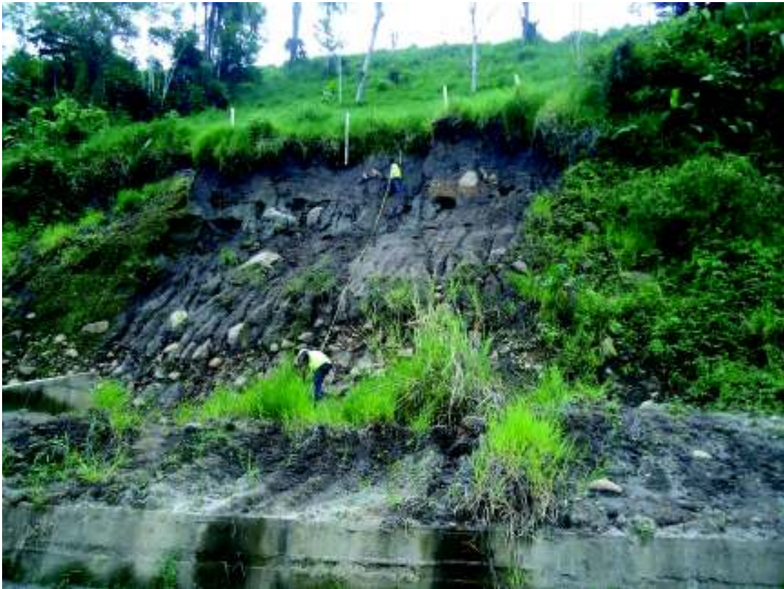
Fotografía 3.1 Caracterización y toma de datos de un talud afectado por un deslizamiento. (UTM, WGS 84: 757252E; 17661N).
