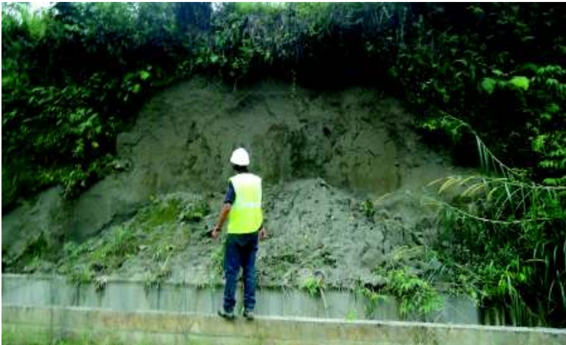
Fotografía 4.2 Deslizamiento D-011. (UTM, WGS 84: 757742E; 17383N).
