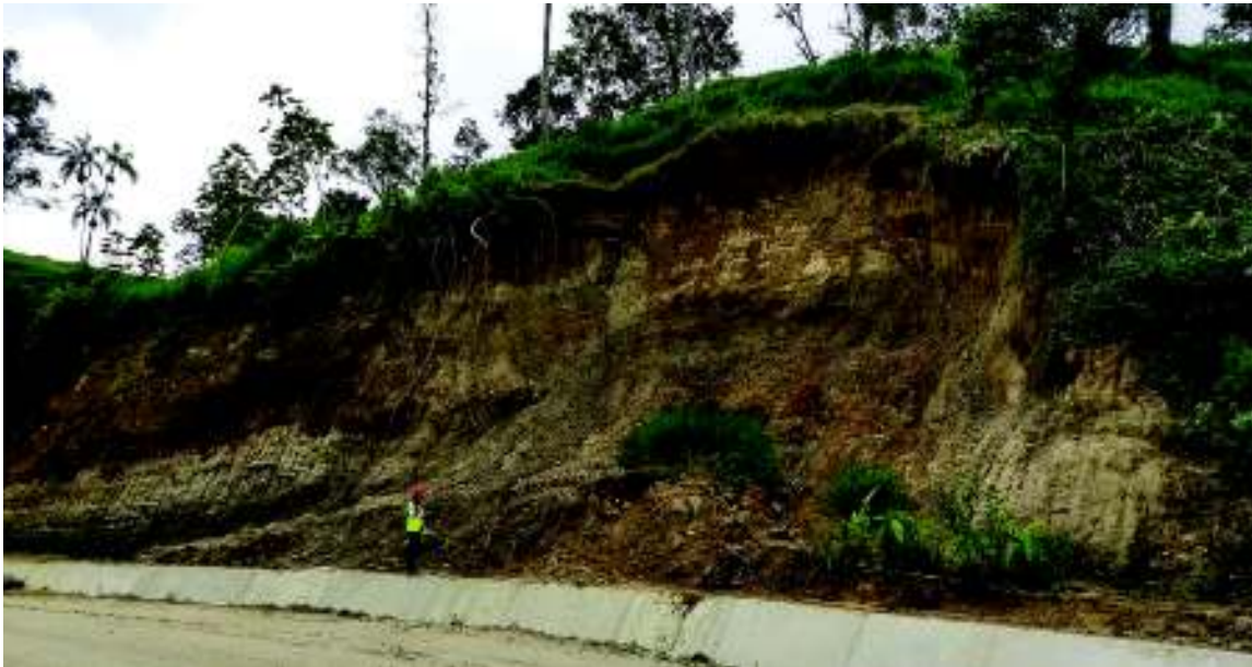
Fotografía 4.15 Deslizamiento DD-003. (UTM, WGS 84: 757243E; 18764N).
