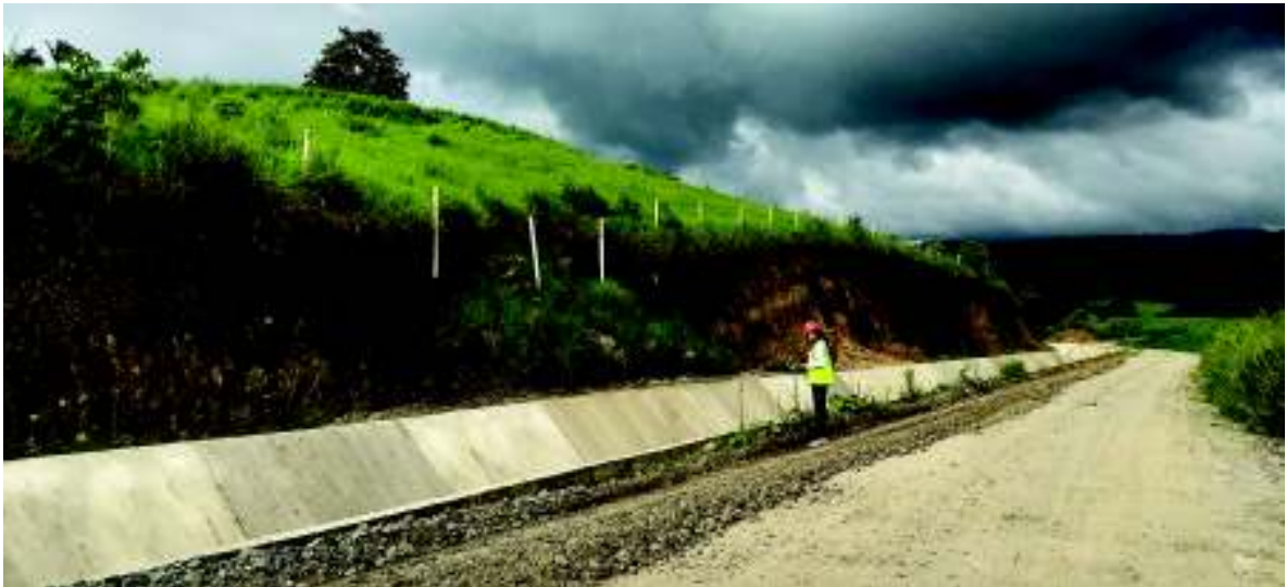
Fotografía 4.19 Deslizamiento D-008. (UTM, WGS 84: 757079E; 19426N).
