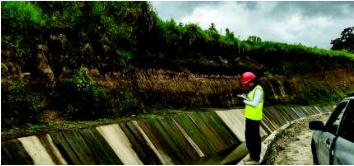
Fotografía 4.20 Deslizamiento D-009. (UTM, WGS 84: 757084E; 19736N).
