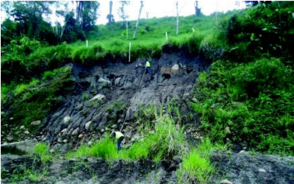
Fotografía 4.6 Deslizamiento DD-002. (UTM, WGS 84: 757252E; 17661N).
