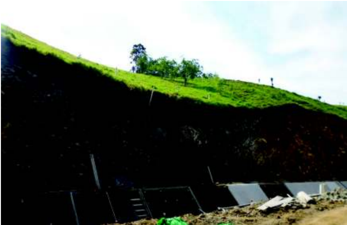
Fotografía 4.8 Deslizamiento D-002. (UTM, WGS 84: 757106E; 17987N).
