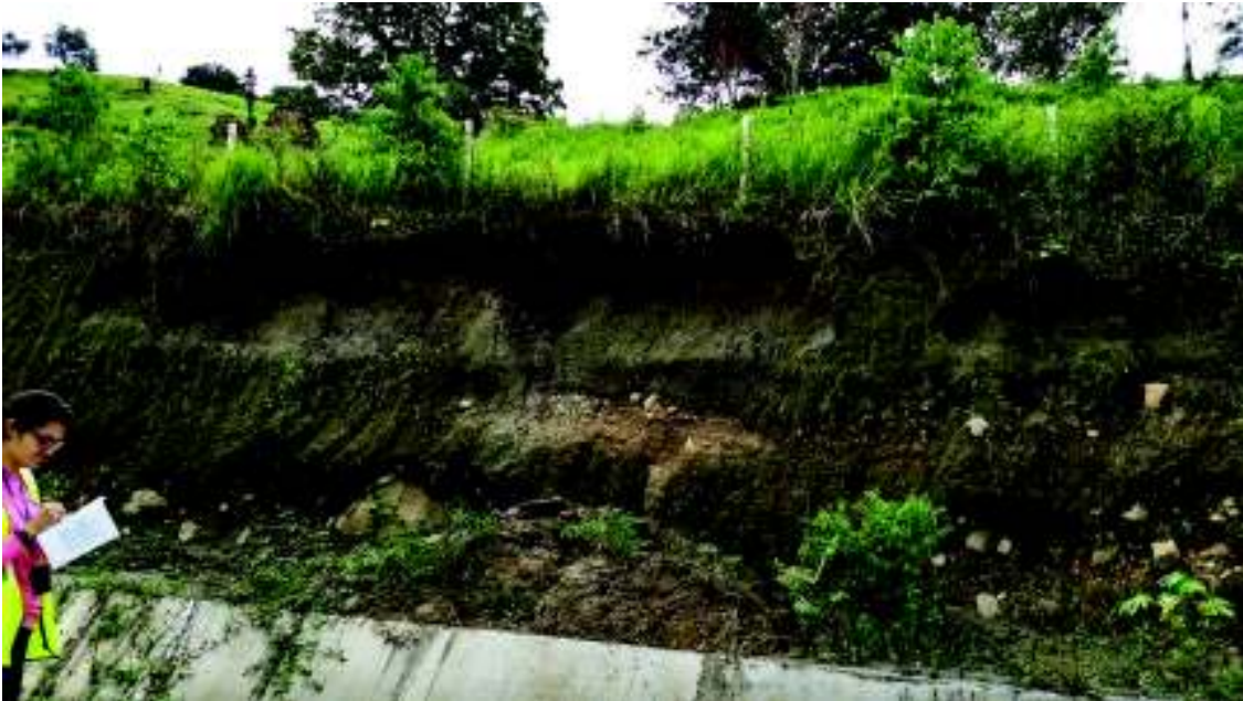
Fotografía 4.7 Deslizamiento D-001. (UTM, WGS 84: 757095E; 17830N).
