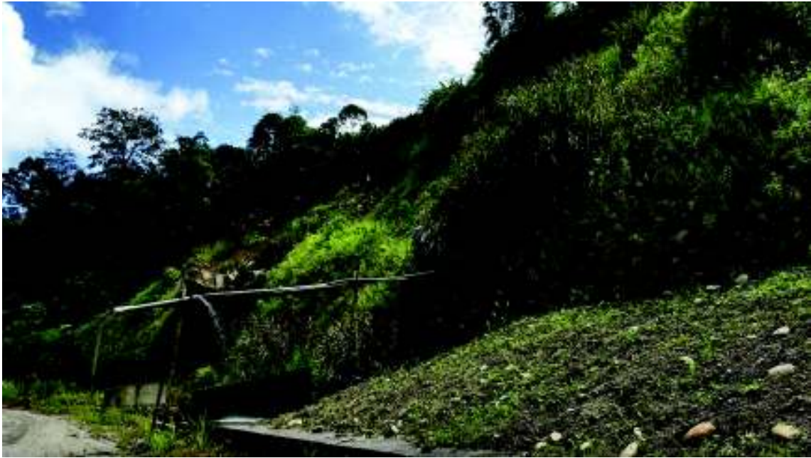
Fotografía 4.4 Deslizamiento DD-001. (UTM, WGS 84: 757444E; 17596N).
