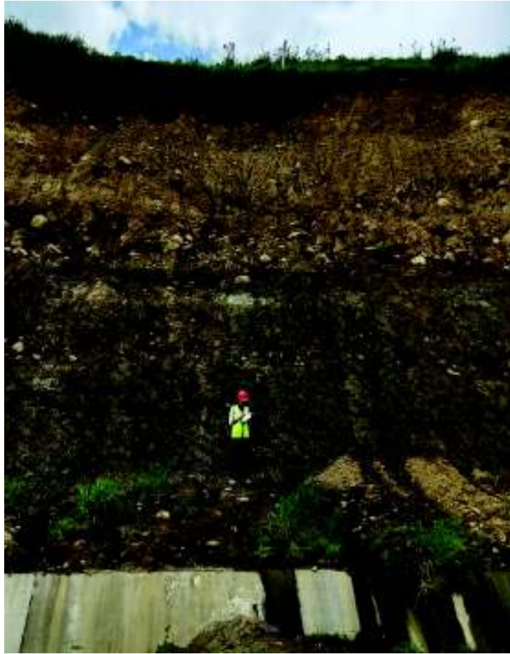
Fotografía 4.12 Deslizamiento D-012. (UTM, WGS 84: 757083E; 18442N).
