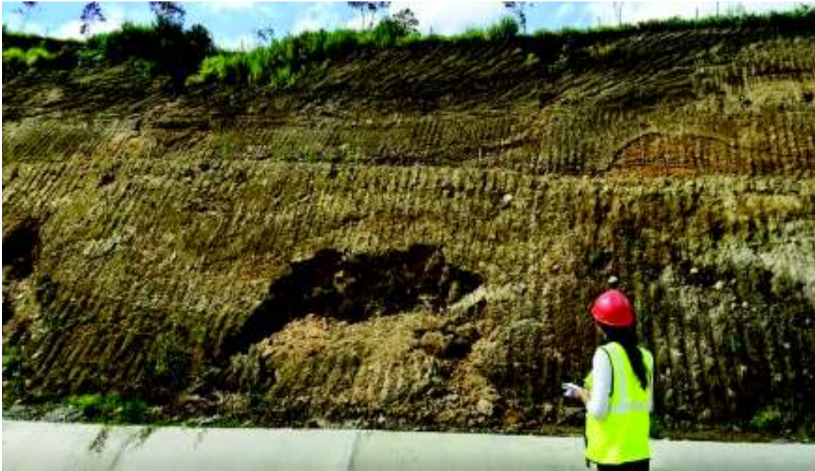
Fotografía 4.13 Deslizamiento D-014. (UTM, WGS 84: 757203E; 18579N).
