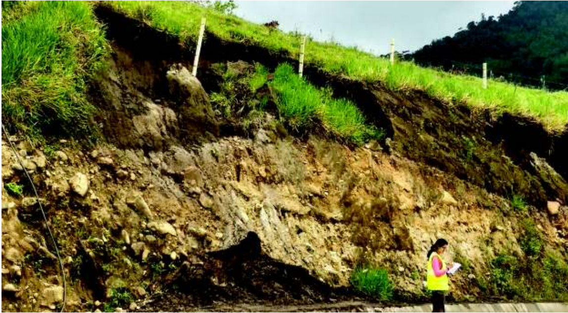
Fotografía 4.9 Deslizamiento D-003. (UTM, WGS 84: 757017E; 18195N).
