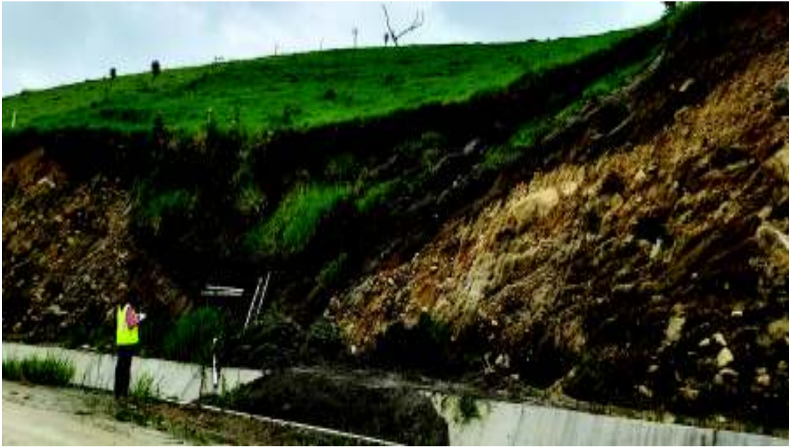
Fotografía 4.10 Deslizamiento D-004. (UTM, WGS 84: 757038E; 18273N).
