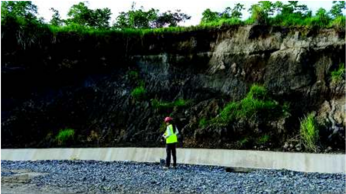
Fotografía 4.18 Deslizamiento D-007. (UTM, WGS 84: 757151E; 19103N).
